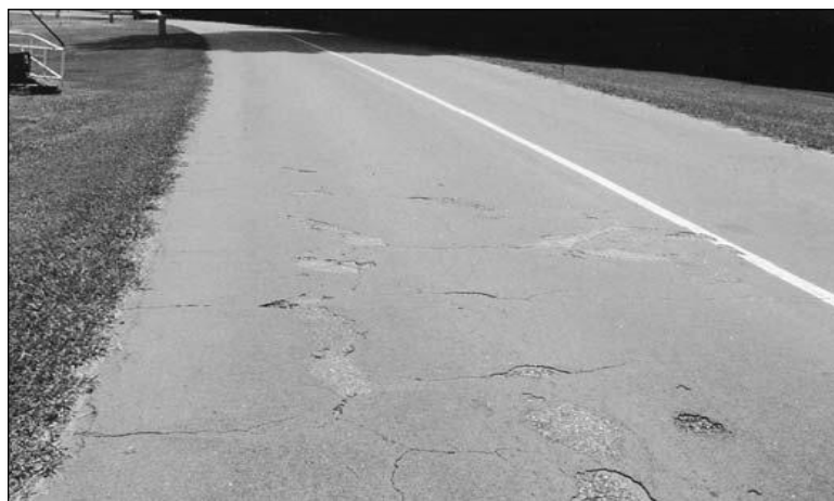
FIGURA 76: Severidad Alta (H) de Peladura por Intemperismo FUENTE: American society for testing and materials, 2018.
