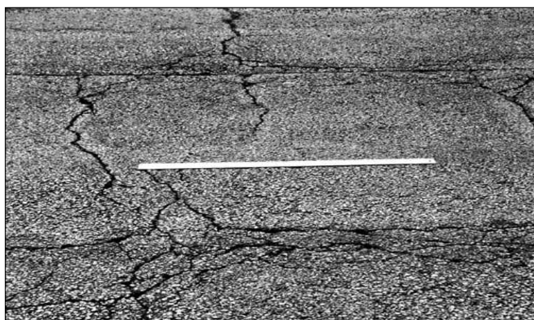
FIGURA 33: Severidad Baja de Fisuras por Bloques(L)
