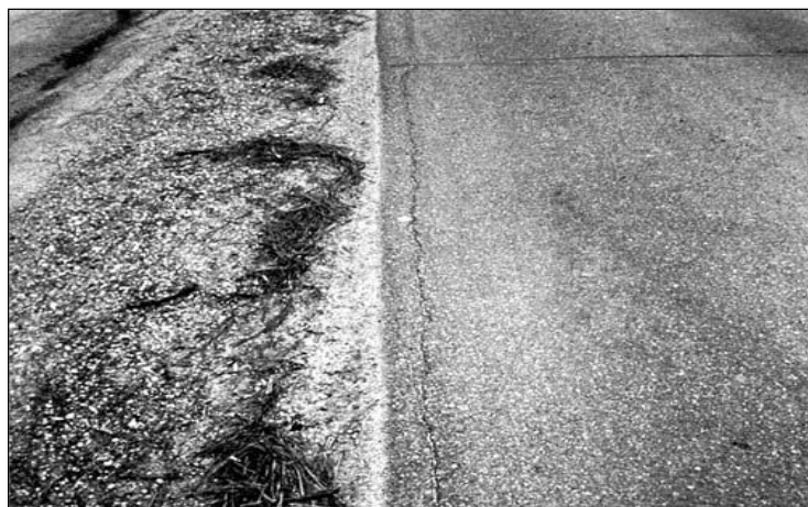
FIGURA 45: Severidad Bajo (L) de Fisura de Borde FUENTE: American society for testing and materials, 2018.
