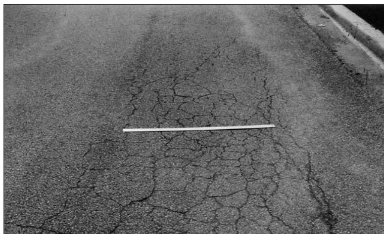
FIGURA 28: Severidad Media de Piel de Cocodrilo (M) FUENTE: American Society for Testing and Materials, 2018
