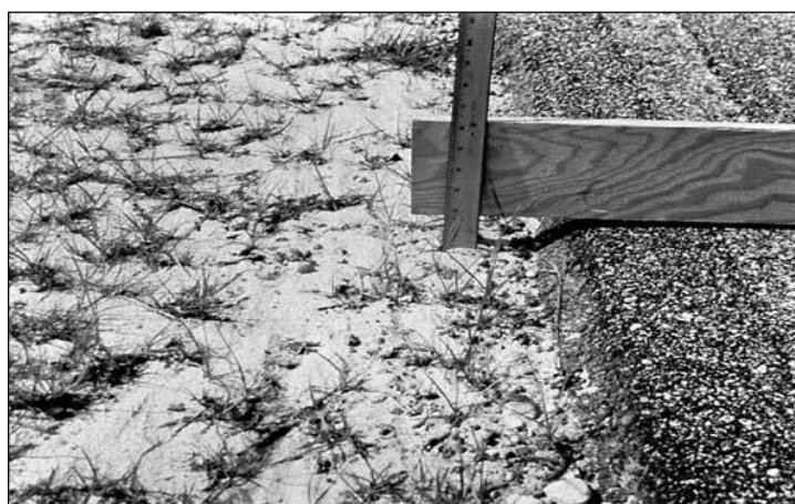
FIGURA 51: Severidad Bajo (L) Desnivel Carril-Berma. FUENTE: American society for testing and materials, 2018.
