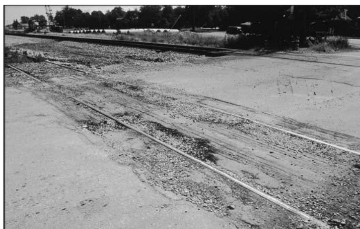
FIGURA 79: Severidad Alta (H) Cruce de Vía Férrea. FUENTE: American society for testing and materials, 2018.
