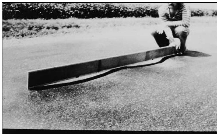
FIGURA 41: Severidad Alto (H) Corrugación.
