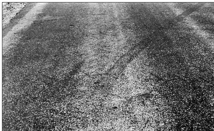
FIGURA 30: Bajo nivel de Severidad de Exudación (L) FUENTE: American Society for Testing and Materials, 2018
