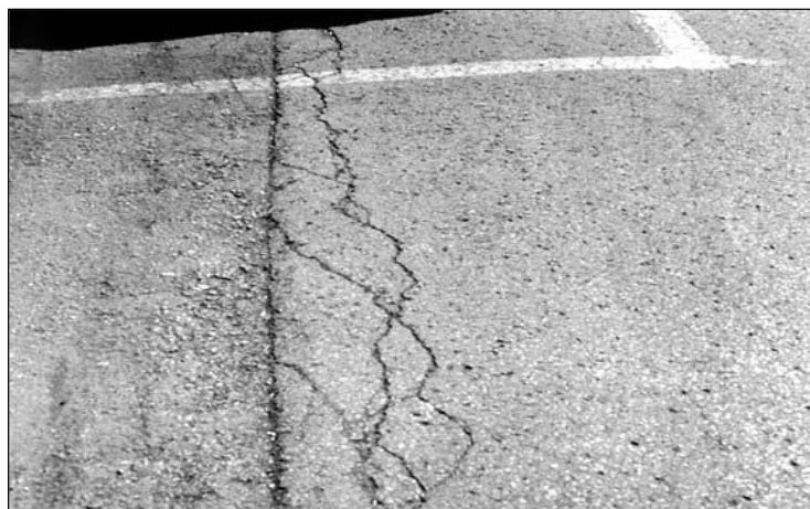
FIGURA 46: Severidad Medio (M) de Fisura de Borde. FUENTE: American society for testing and materials, 2018.
