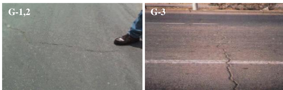
FIGURA 89: Gravedad 1, 2,3; Fisuras Transversales.
