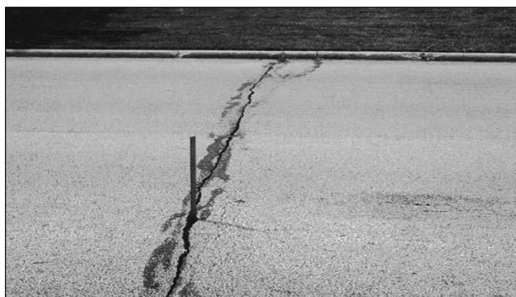
FIGURA 55: Severidad Medio (M) Fisuras Longitudinales y Transversales FUENTE: American society for testing and materials, 2018)
