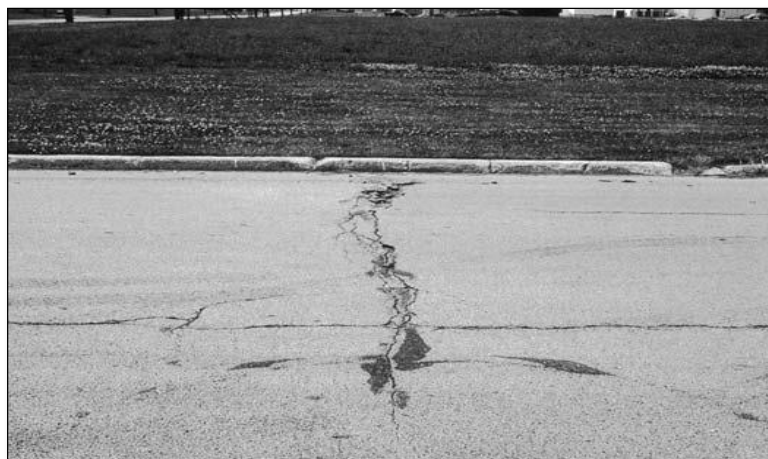
FIGURA 56: Severidad Alto (H) Fisuras Longitudinales y Transversales FUENTE: American society for testing and materials, 2018.
