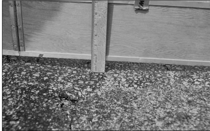
FIGURA 66: Severidad Alto (H) de Ahuellamiento. FUENTE: American society for testing and materials, 2018.
