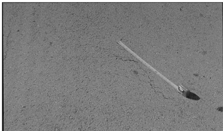
FIGURA 70: Sev. Baja (L) de Fisuras Parabólicas por Deslizamiento FUENTE: American society for testing and materials, 2018.
