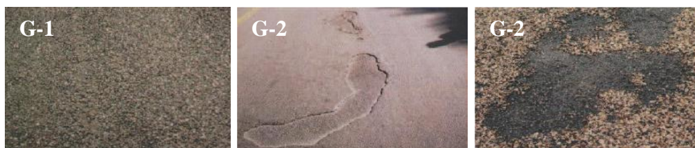
FIGURA 87: Gravedad 1, 2,3; Peladura Superficial.
