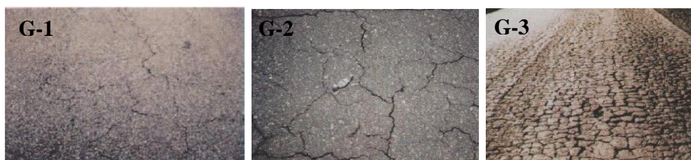
FIGURA 81: Magnitud de Falla, Piel de Cocodrilo
