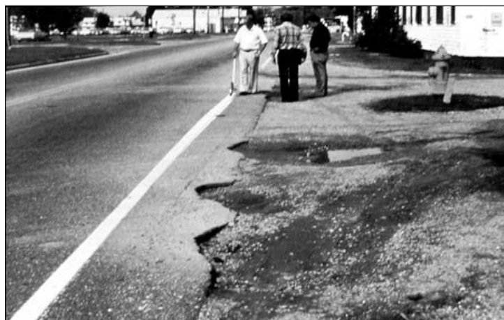
FIGURA 47: Severidad Alto (H) de Fisura de Borde.
