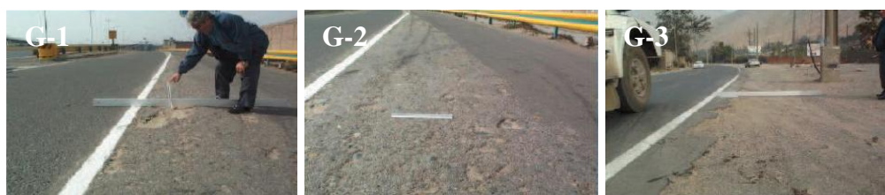
FIGURA 91: Gravedad 1,2,3; Daños en Bermas.
