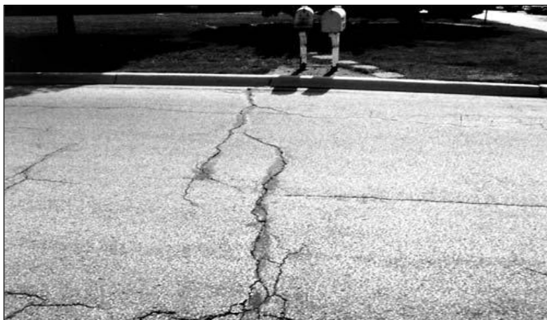
FIGURA 34: Severidad Media de Fisuras en Bloque (M)
