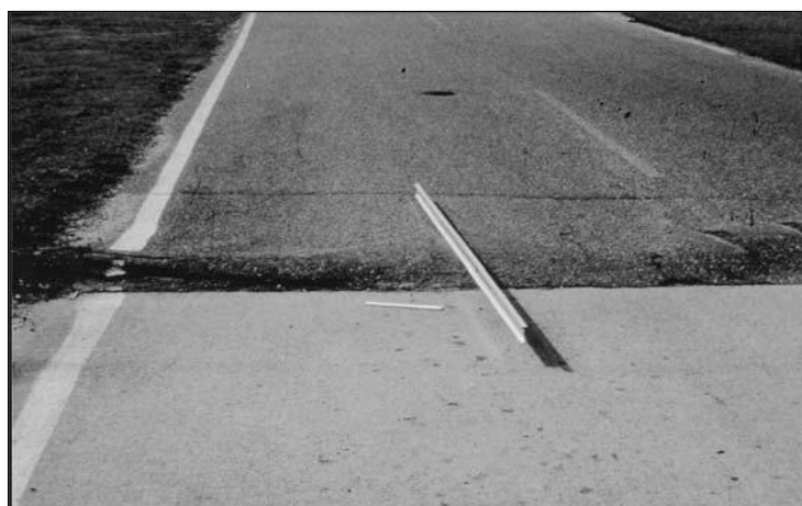
FIGURA 69: Severidad Alta (H) de Desplazamiento. FUENTE: American society for testing and materials, 2018.
