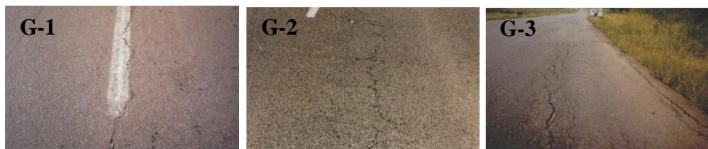
FIGURA 82: Magnitud de Falla, Fisuras Longitudinales.
