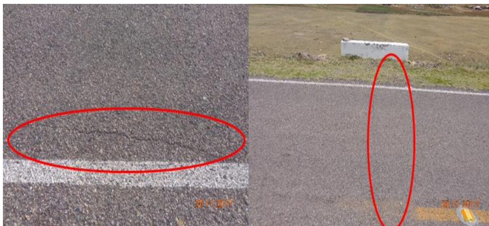
FIGURA 101: Falla de fisuras longitudinales y transversales FUENTE: Propia.
