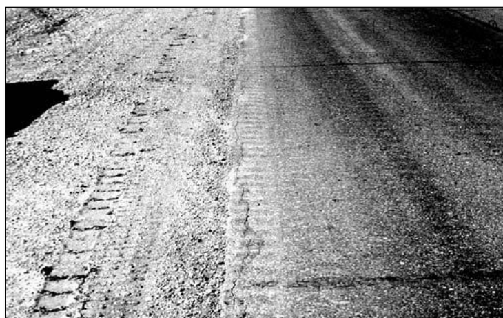
FIGURA 48: Severidad Bajo (L) de Fisuras de Reflexión de Junta.
