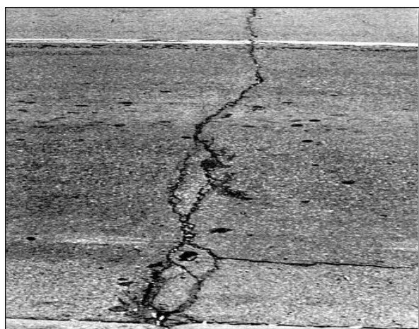
FIGURA 49: Severidad Media (M) de fisuras de reflexión de junta. FUENTE: American society for testing and materials, 2018.
