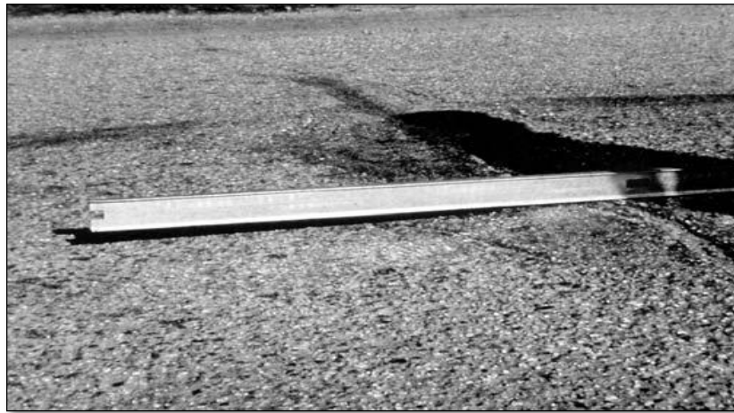
FIGURA 36: Severidad Bajo (L) en Abultamientos y Hundimientos FUENTE: American society for testing and materials, 2018
