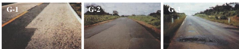
FIGURA 86: Gravedad 1, 2,3; Reparación o Parchado
