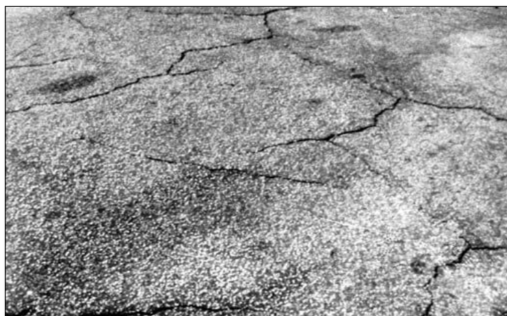
FIGURA 35: Severidad Alta de Fisuras en Bloque(H)
