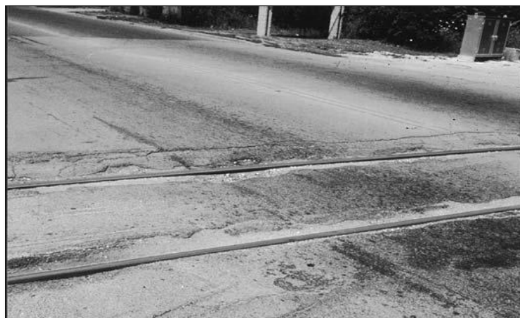
FIGURA 78: Severidad Media(M) Cruce de Vía Férrea FUENTE: American society for testing and materials, 2018.
