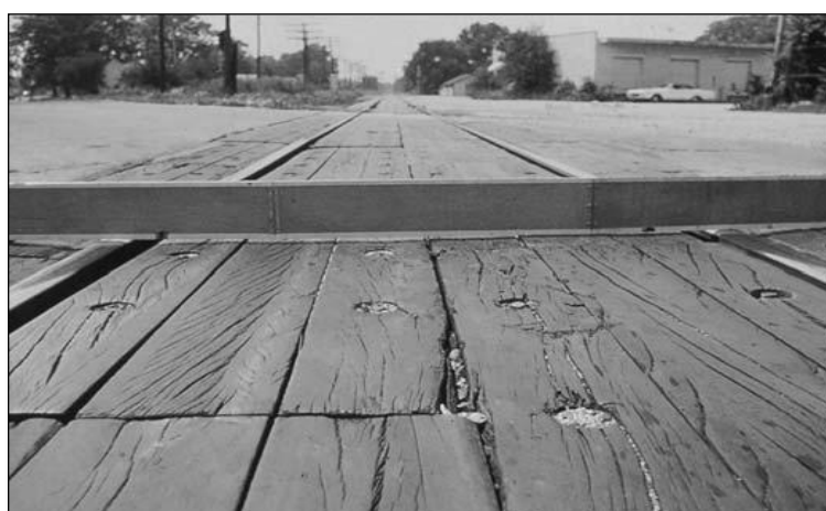
FIGURA 77: Severidad Baja (L) Cruce de Vía Férrea FUENTE: American society for testing and materials, 2018.
