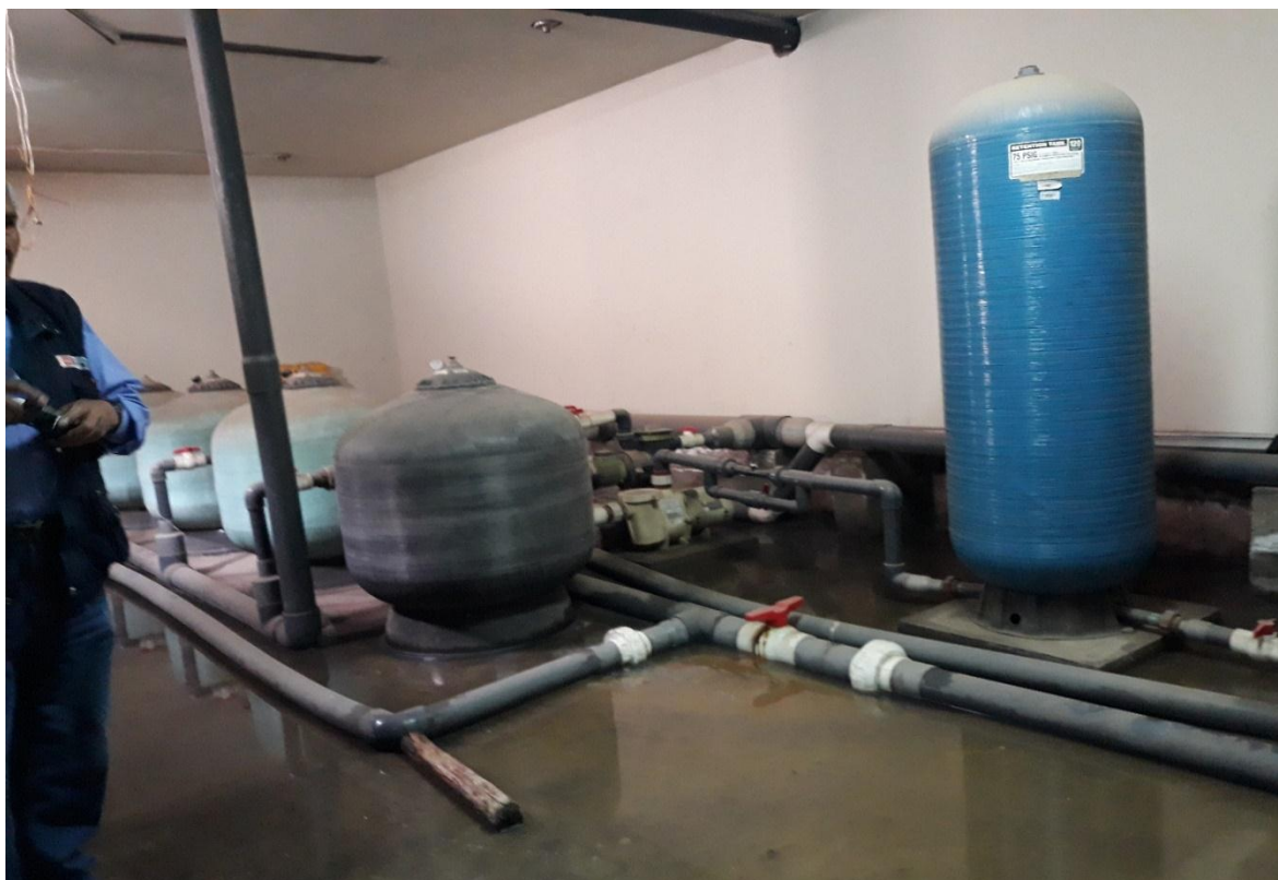
Figura 29. Sistema de recirculación de la piscina Municipal, julio – noviembre del 2018.
