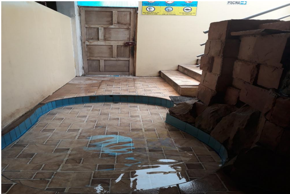
Figura 28. La imagen muestra un lavapies de la piscina Paraiso lo cual toda piscina debe disponer, limpios y con solución desinfectante, julio – noviembre del 2018.
