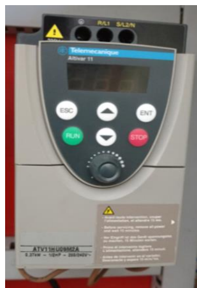
Figura 3.11. Fotografía del variador de velocidad.
