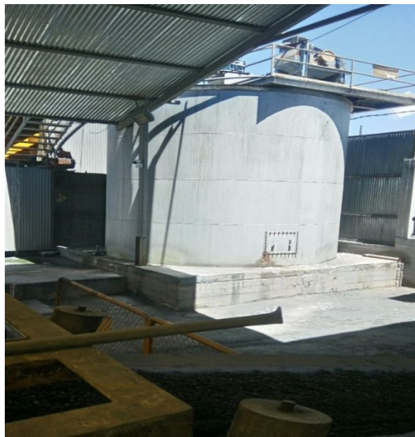
FIGURA N° 16: Fotografía del Tanque de Lixiviación actual 20ft x 20ft
