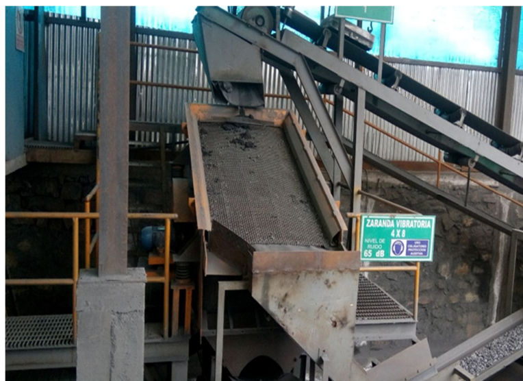
FIGURA N° 19: Fotografía de la Zaranda Vibratoria
