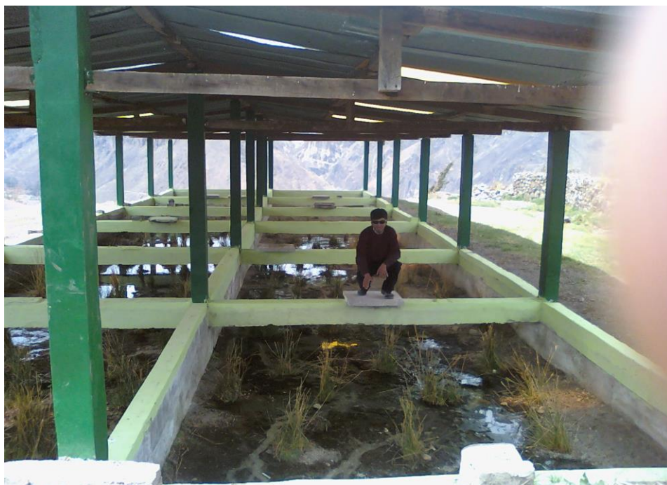
Figura 19. Sistema de tratamiento de agua residual etapa secundaria con en donde se aprecia las densidades de siembra.
