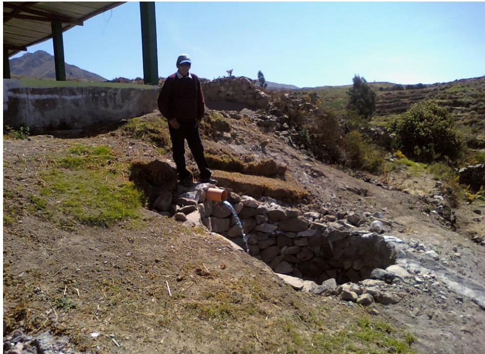
Figura 20. Sistema de tratamiento de agua residual etapa terciaria.
