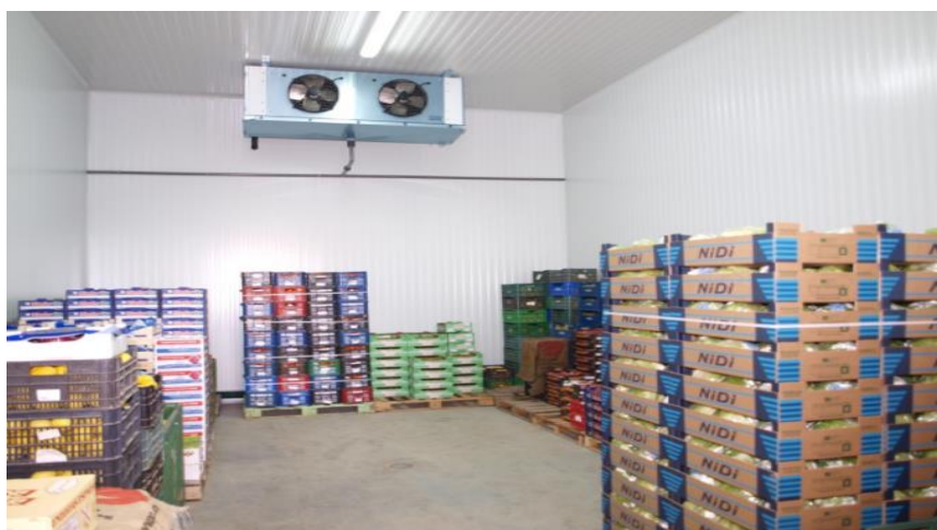
FIGURA 2.12: Cámara de conservación de frutas y verduras
