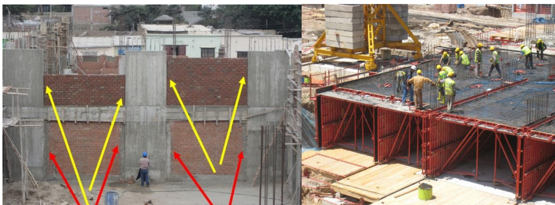
FIGURA 5.28: Colocación con guía de concreto prefabricado FUENTE: Con la Tecnología de Blogger
