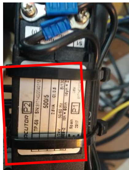
FOTO 07.- Placa de Datos de Transformador de Corriente CIRCUTOR (Relación de Transformación de 500/5; 60 Hz)
