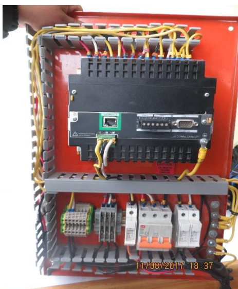
FOTO 03.- Panel Posterior ION 7650 (Configuración eléctrica de Medidor)
