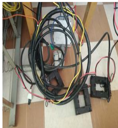
FOTO 08.- Transformadores de Corriente CIRCUTOR.
