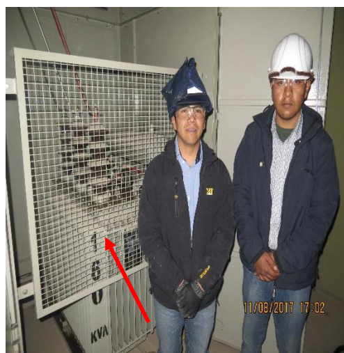
FOTO 10.- Transformador Eléctrico Principal de Planta Industrial de Procesamiento de Quinua CIRNMA
