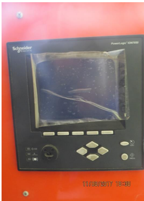
FOTO 01.- Medidor ION 7650 Marca Schneider Electric (Panel Frontal)
