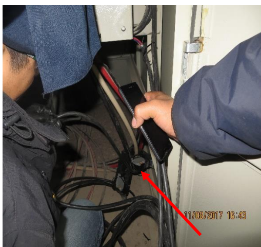
FOTO 14.- Transformadores de Corriente CIRCUTOR modelo TP-58 500/5 instalados aguas abajo del transformador (Entre Transformador y carga industrial)
