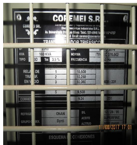
FOTO 11.- Placa de Datos de Transformador Eléctrico (Potencia Aparente = 160 KVA, Ucc = 3.5 %, ONAN refrigeración natural, Configuración Dyn5)
