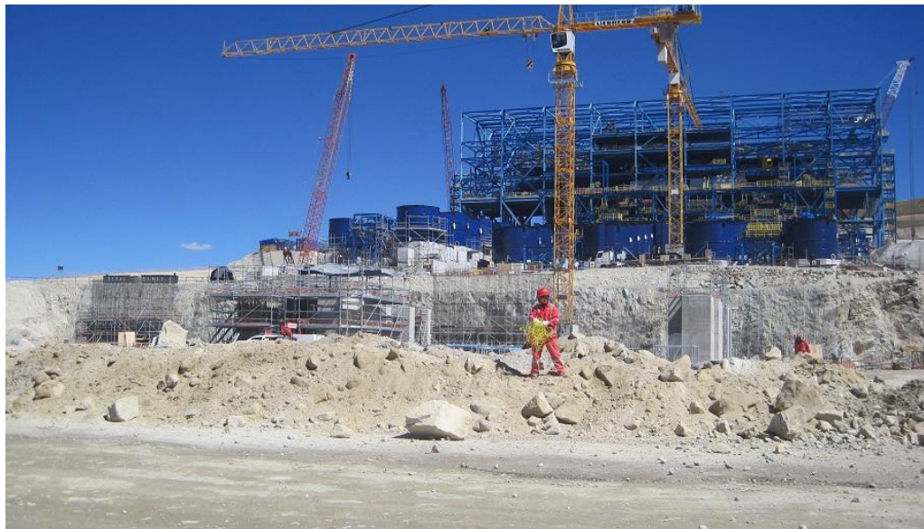
Figura N° 64: Integridad de las estructuras cercanas tras la voladura
