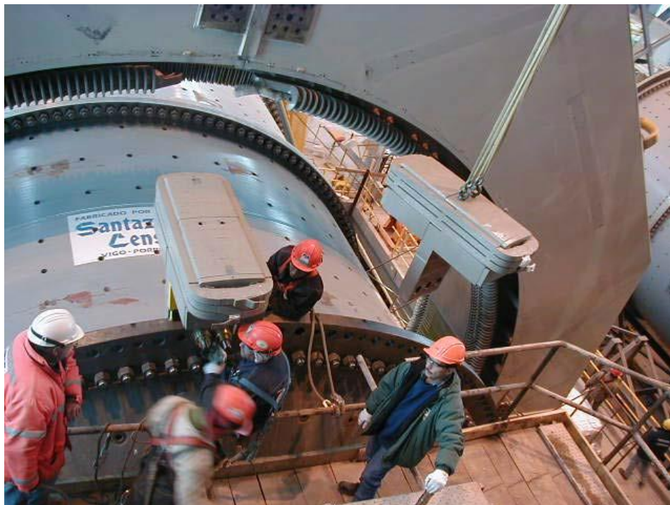
Figura N°2. 19: Instalación de polo en carcasa de molino – rotor.
