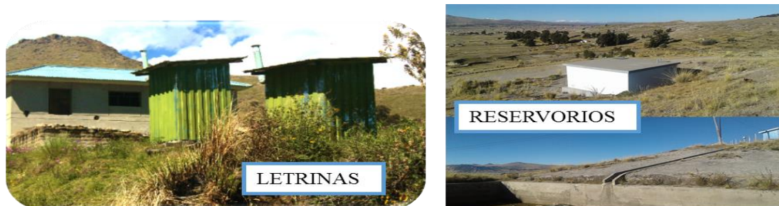
Figura 45. Instalaciones de agua y desagüe.
