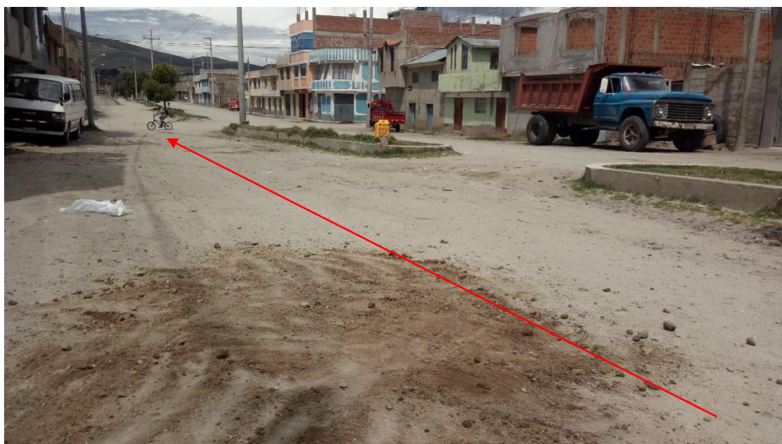
Foto 1: Vista panorámica de la condición actual de la avenida circunvalación
