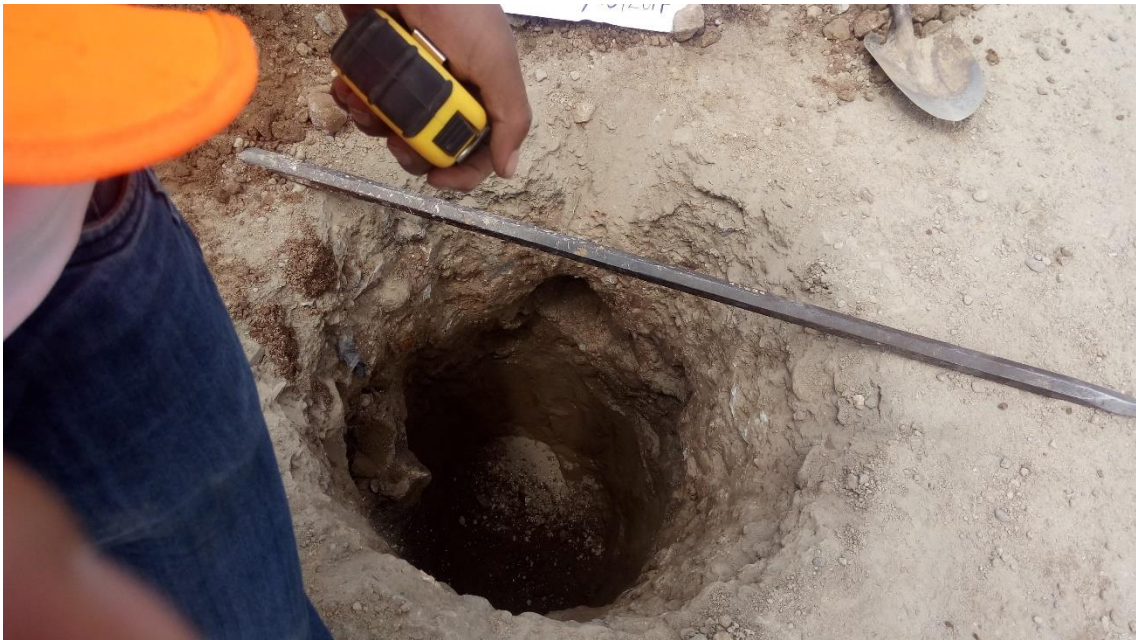
Foto 6: Vista en Planta del pozo Calicata donde se aprecia la profundidad de excavación.
