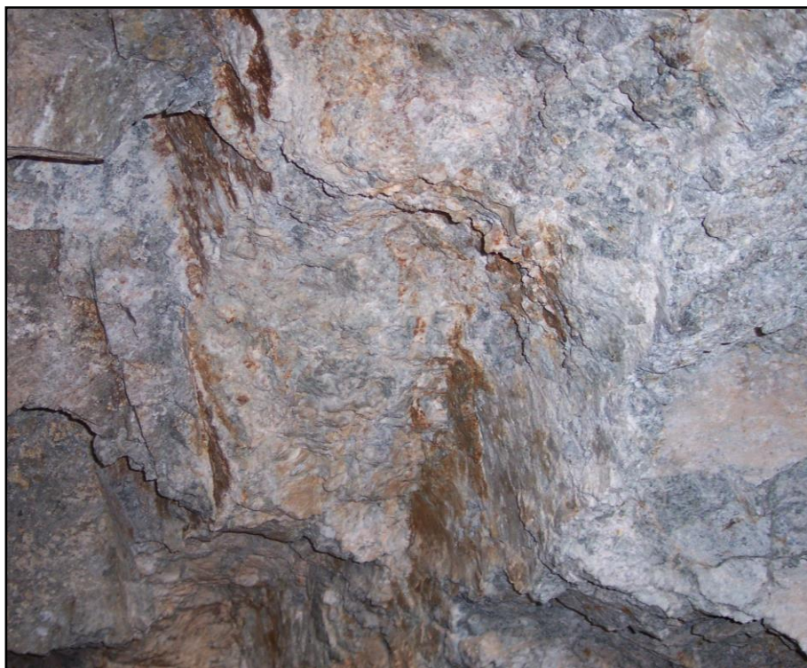
Figura N° 10: Zona de cizallamiento con dirección al rumbo de la falla.
