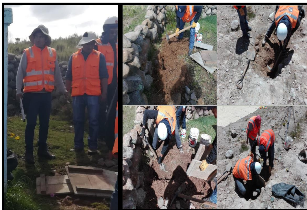
Figura 31: Excavación rectangular para la monumentación de 0.40 x 0.40 de cara y 0.60 de enterrado.
