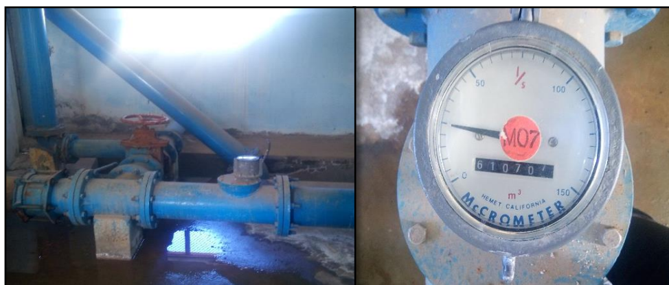
FIGURA 3 MACROMEDIDOR DEL RESERVORIO “PARQUE INDUSTRIAL R-850” FUENTE: PROPIA
