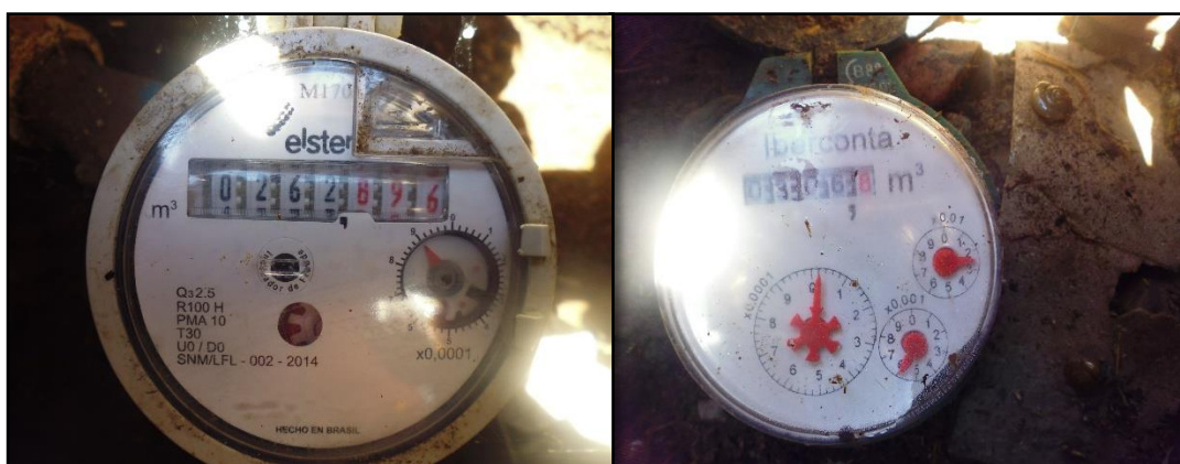
FIGURA 4 MICROMEDIDORES DE LAS VIVIENDAS EN LAS MARCAS ELSTER FUENTE: PROPIA
