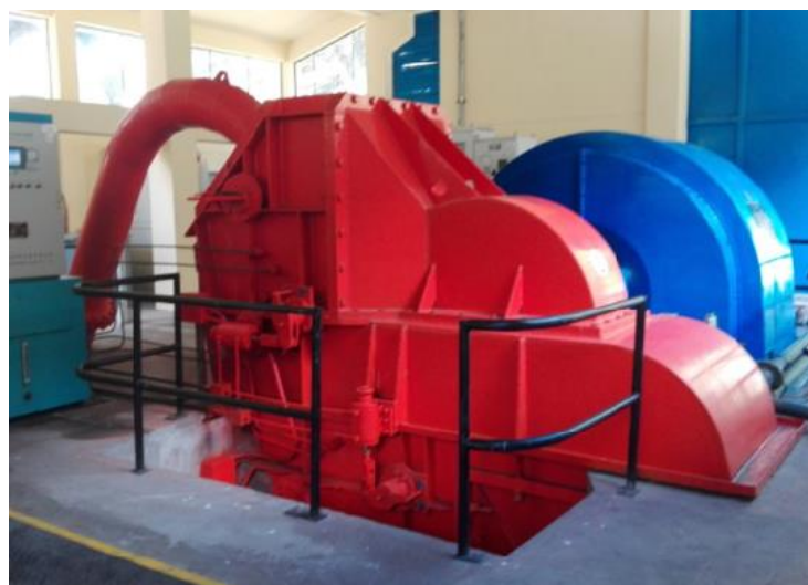
Figura 4.4: Fotografía Tercer grupo turbina-generator
