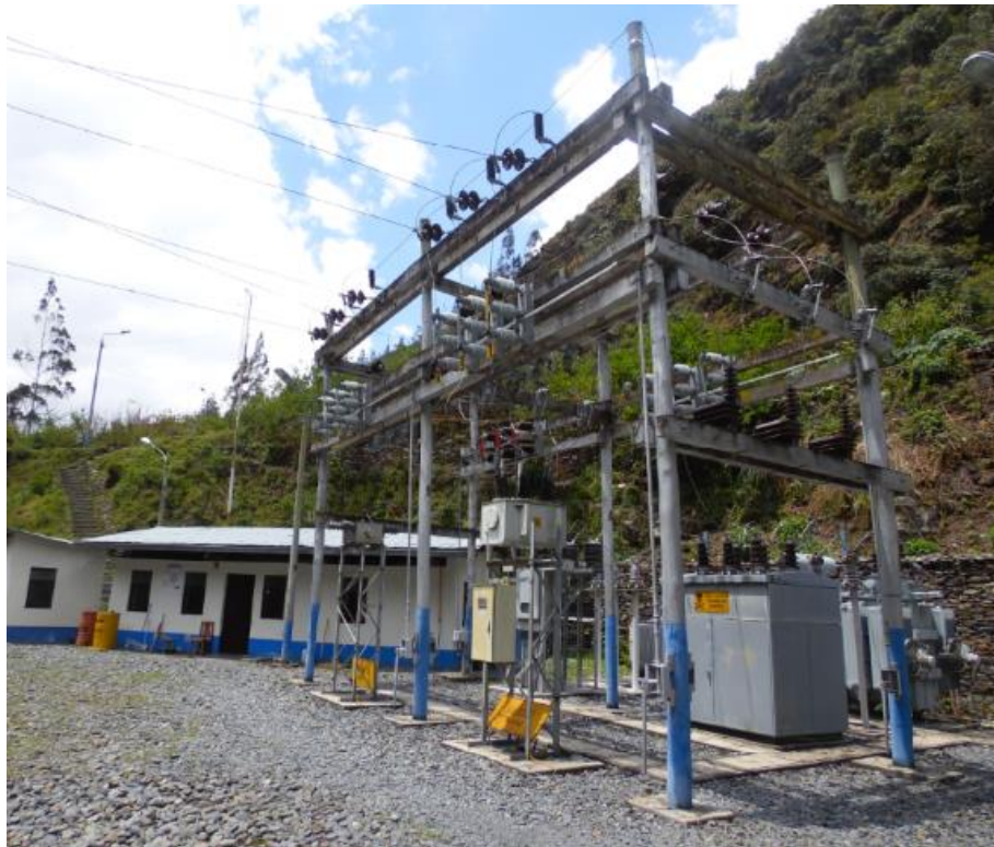
Figura 4.2: Fotografía Líneas de transmisión de 22.9 kV.
