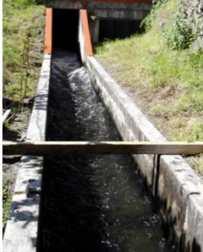
Figura 4.5: Fotografía canal de desfogue del tercer grupo turbina-generador
