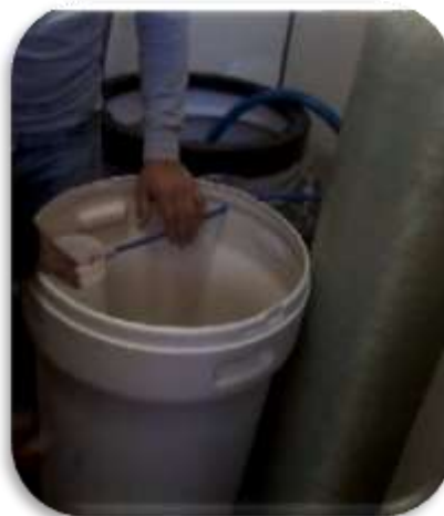
Fotografía 8: tanque de sal muera
