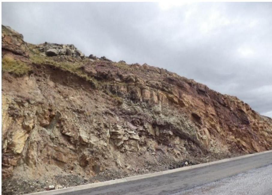
FIGURA N° 39: Se aprecian tres familias de discontinuidades en el macizo rocoso del talud Progresiva Km 20+080- Km 20+160.
