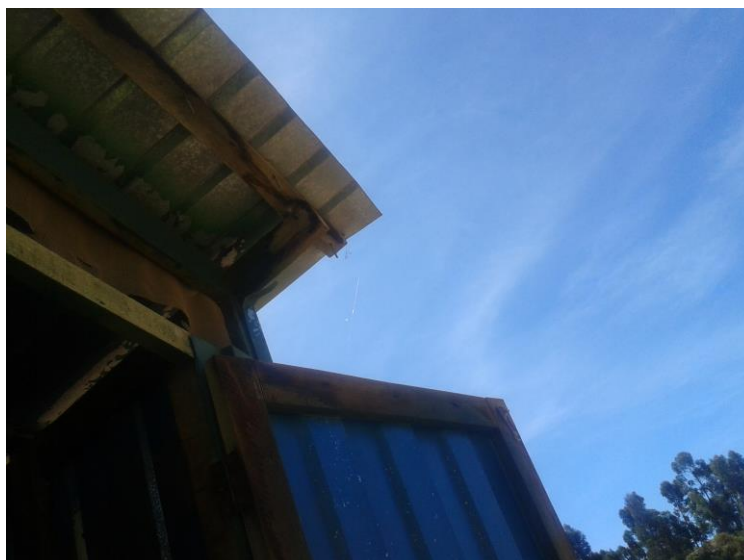
Figura 4: UBS con techo en regular estado
