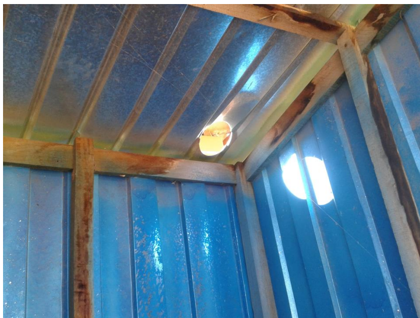
Figura 2: UBS sin tubo de ventilación Fuente: Elaboración propia
