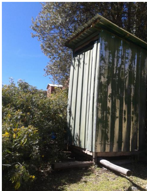
Figura 6: UBS con señales visibles de entrada de agua de lluvia
