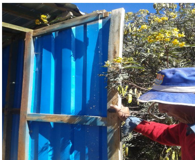
Figura 3: UBS con puerta en mal estado Fuente: Elaboración propia
