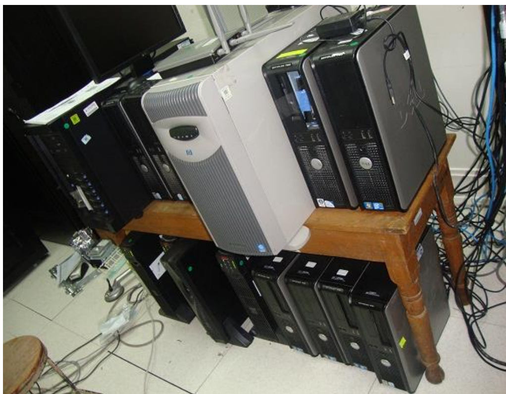
Figura N° 11: Centro de Datos de la CSJ Puno - Equipos Servidores Previo a la Virtualización.
