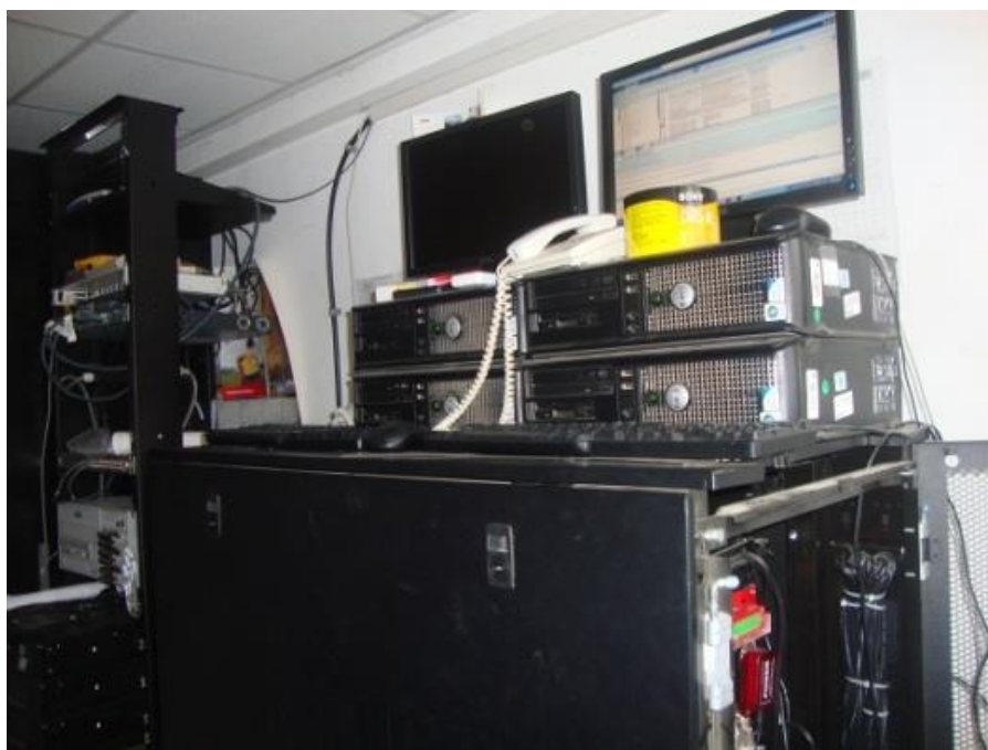
Figura N° 13: Centro de Datos de la CSJ Puno - Infraestructura heterogénea, requiere mayor esfuerzo de administración de diversas plataformas.
