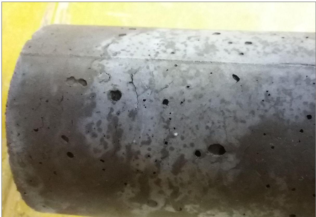
FOTOGRAFÍA 08: FISURA DE CONCRETO CURADO EN CONDICIÓN CRÍTICA
