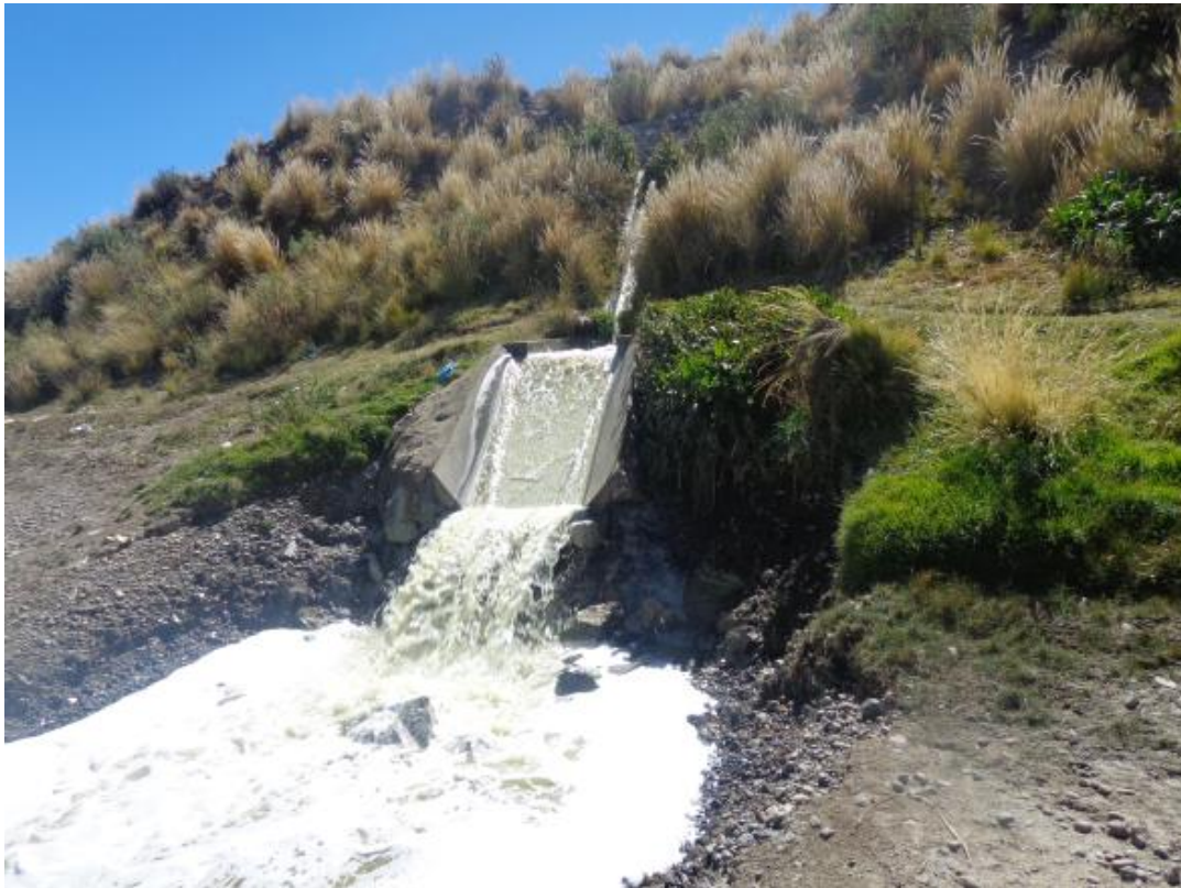
Figura 101.- Salida del efluente tratado al río.
