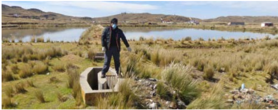
Figura 84.- Tratamiento preliminar actual.
