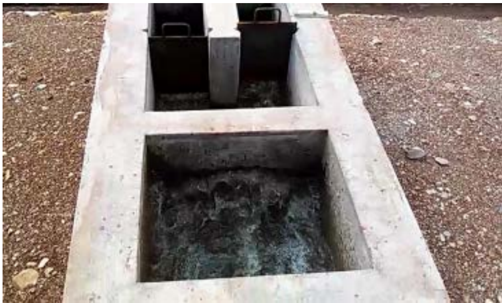
Figura 108.- Repartidor de caudal, Ptar del Distrito de Tilali, Visita técnica. Se verifica que se tiene una excesiva entrada del caudal, esto sucede cuando la población servida incrementa, además esta estructura esta al punto del colapso. En cambio si fuera un canal partidor eso no sucedería.
