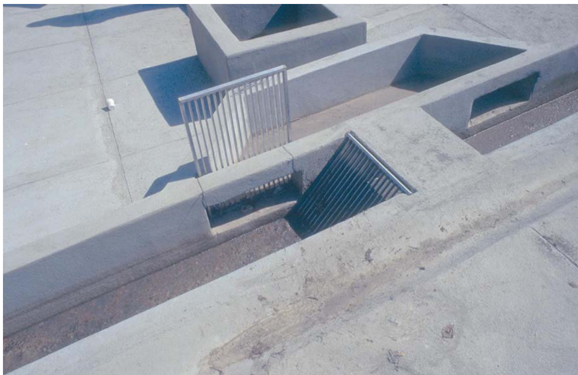
Figura 12.- Rejilla en canal de aproximacion.
