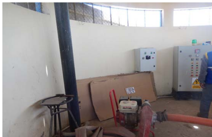
Figura 50.-Equipamiento Del Caisson De Aguas Servidas N° 04 “Caymahui”
