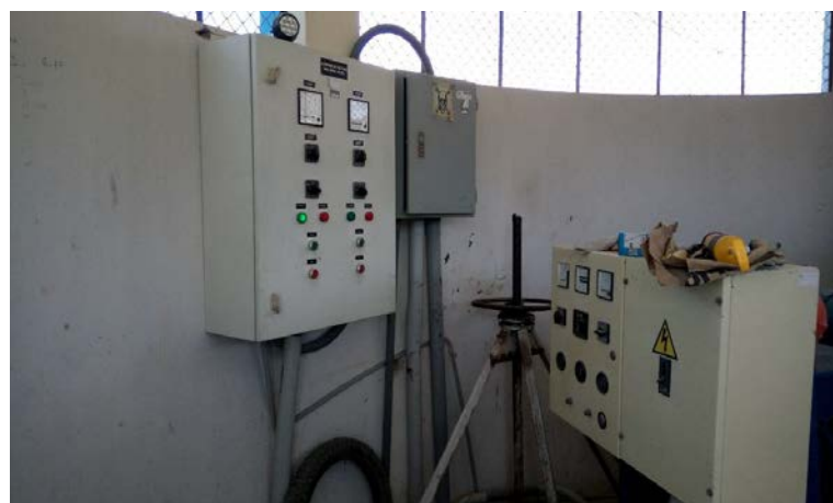
Figura 46.-Equipamiento Del Caisson De Aguas Servidas N° 02 "Peru Birf"
