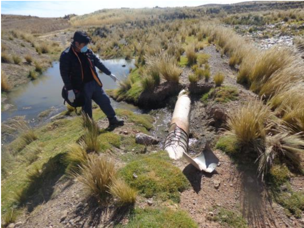
Figura 76.- Emisor dañado (presenta rotura)
