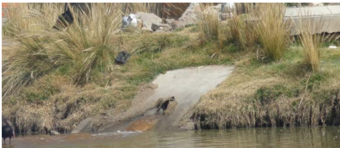
Figura 87.- Estructura de Entrada a la Laguna 01.
