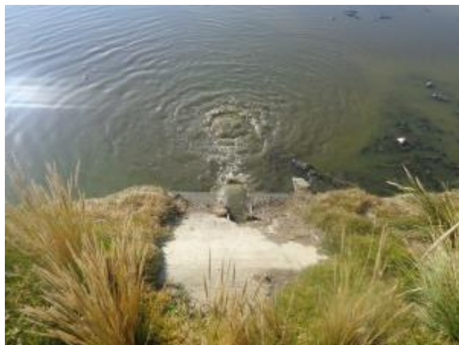
Figura 92.- Acumulación de lodo al ingreso de la laguna. Fuente: Foto tomada (19/05/2017)
