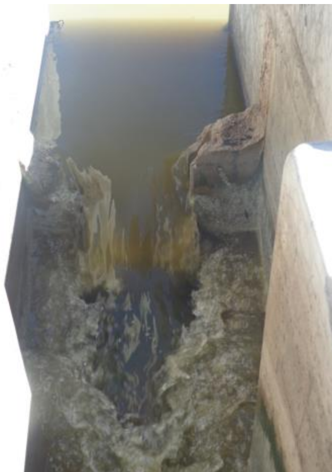
Figura 91.- Condición actual del vertedero de la estructura de salida.
