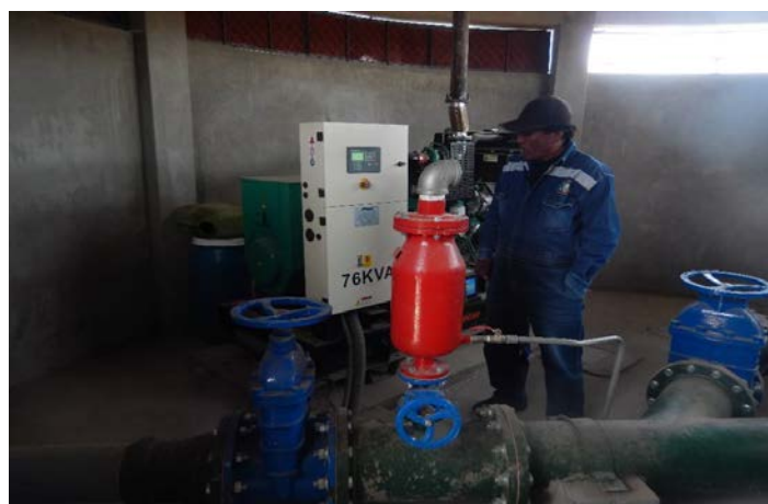
Figura 52.-Equipamiento Del Caisson De Aguas Servidas N° 05 “Rio Blanco”
