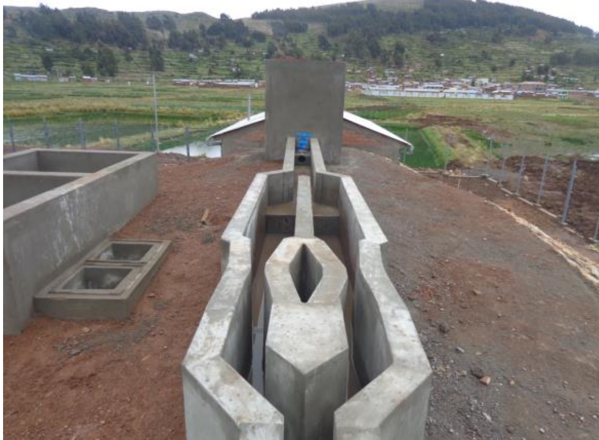
Figura 21.- Canaleta Parshall, Ptar Distrito de Tilali- Provincia de MOHO
