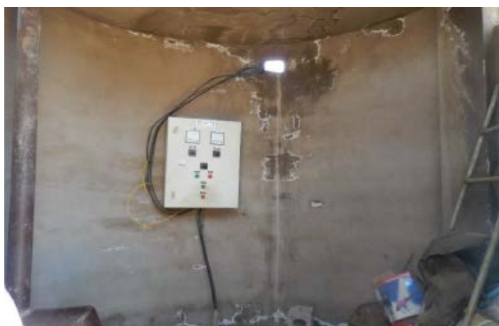
Figura 48.-Equipamiento Del Caisson De Aguas Servidas N° 03 “28 De Julio”
