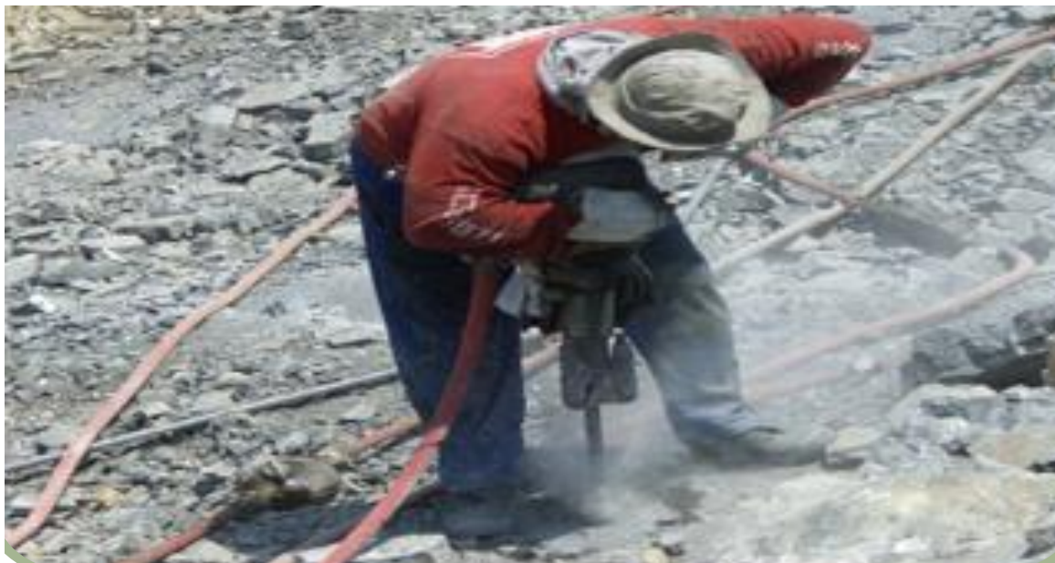
Figura 5. 47. Proceso de perforación con martillo Jack hammer en cantera de caliza La Unión Fuente. Autor de tesis
