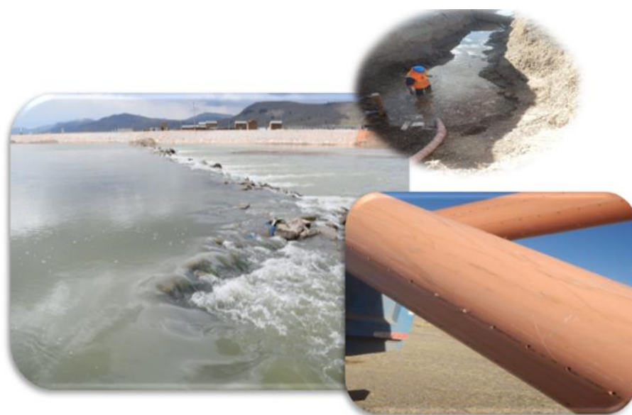
Figura 5 Tubería de galerías filtrantes
