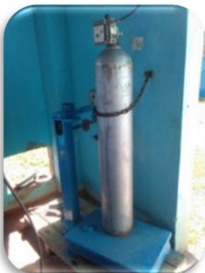
Figura 7 Dosificador de cloro Fuente: Área de control de calidad.
