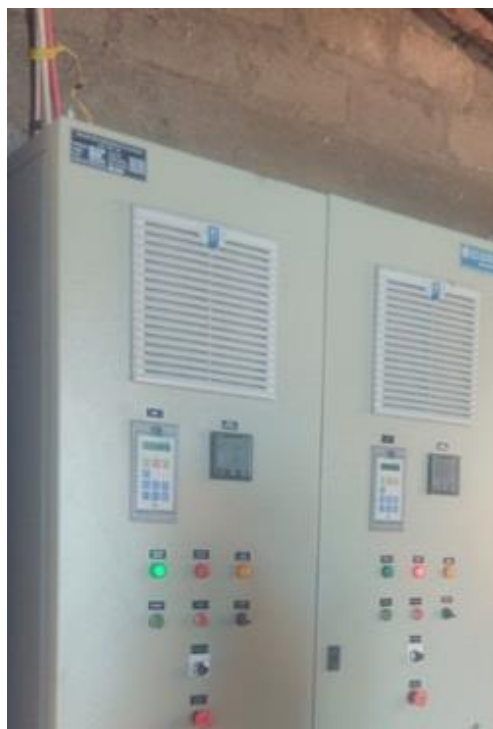
Figura 6 Tablero de Control electrónico
