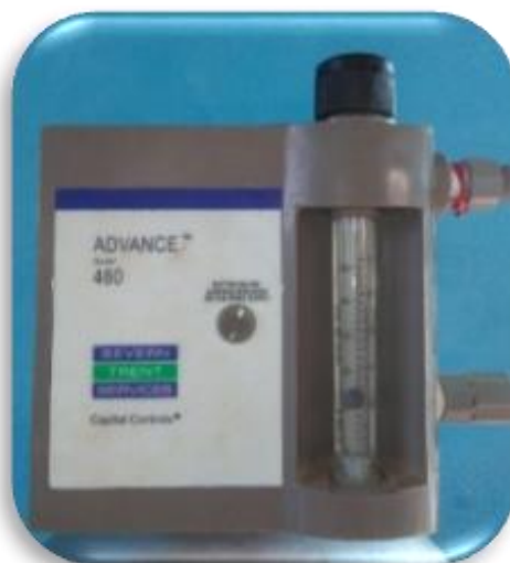
Figura 8 Control de cloro Fuente: Área de control de calidad.
