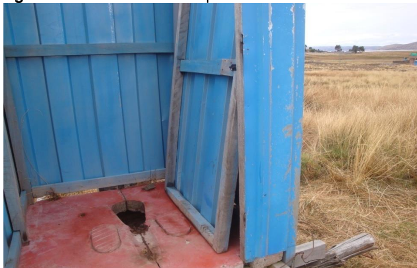
Figura N° 05: La caseta sin puerta.
