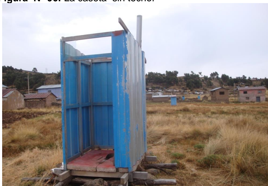
Figura N° 06: La caseta sin techo.
