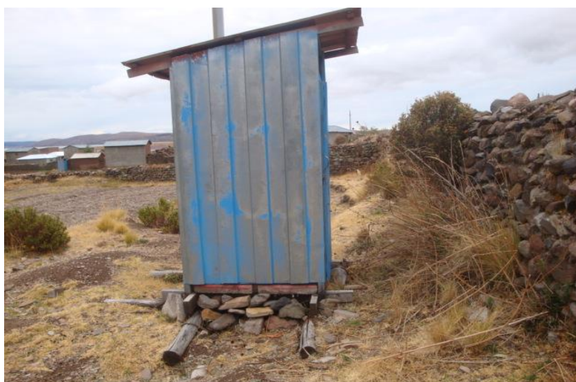
Figura N° 04: La caseta despintada.
