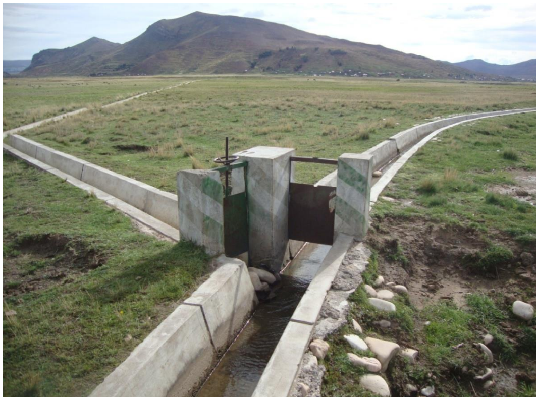
Fotografía N° 6: Se aprecia el canal principal y el canal lateral, además el deterioro de las compuertas los cuales son operados con champas y piedras.
