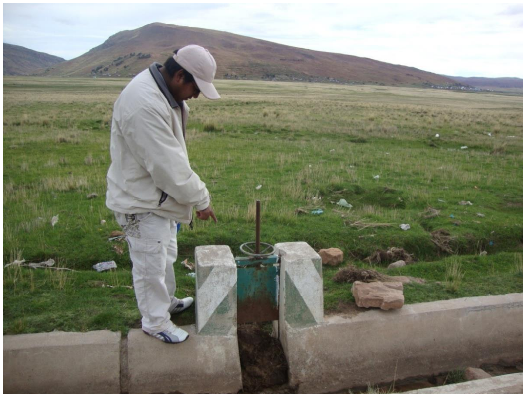
Fotografía N° 4: Se aprecia el deterioro de las tomas, utilizándose en su lugar champas.
