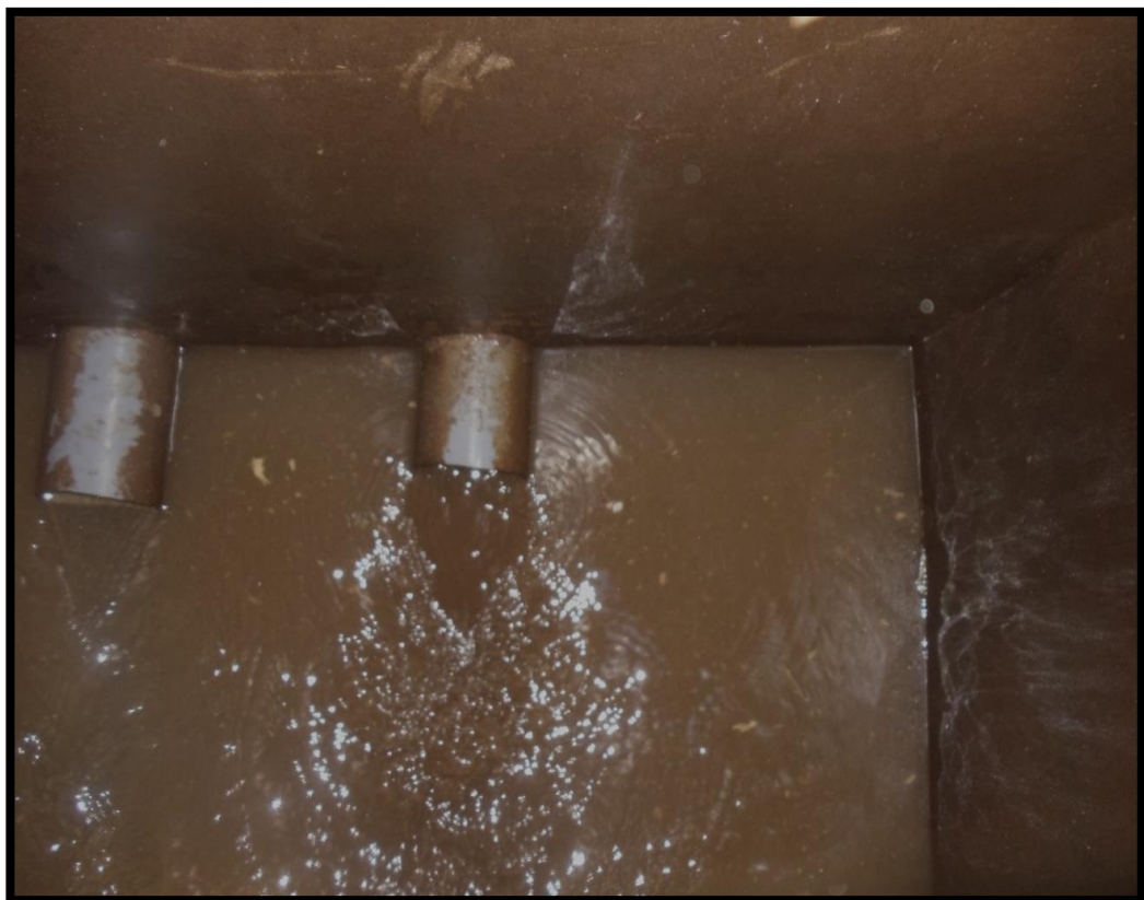
Fotografía 11: Camara humeda donde se muestra la clara turbiedad con que sale el agua
