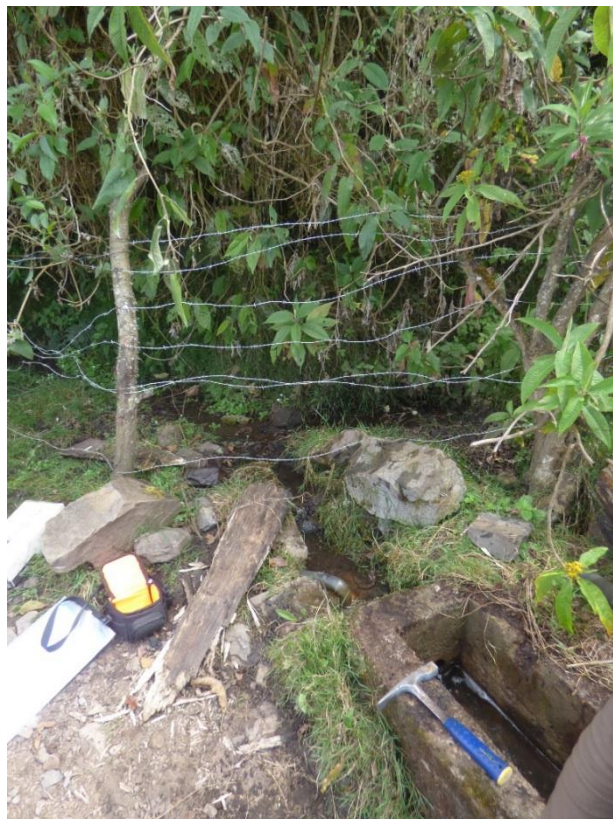
Fotografía N° 3.5. Manantial polisurgente Miskypuquio (499921-046) ubicada en el sector Chaupicruz Huayllabamba, se ha medido un pH ligeramente alcalino de 8.56 en temporada de estío.
