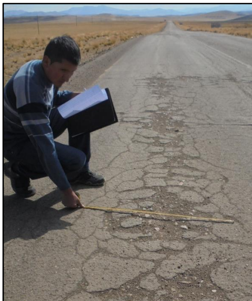
Fotografía N° 6. Falla tipo 1 piel de cocodrilo nivel de severidad alto.
