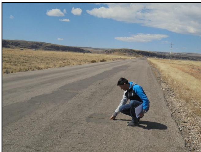
Fotografía N° 3. Falla tipo 11 bacheo y zanjas reparadas del método PCI.
