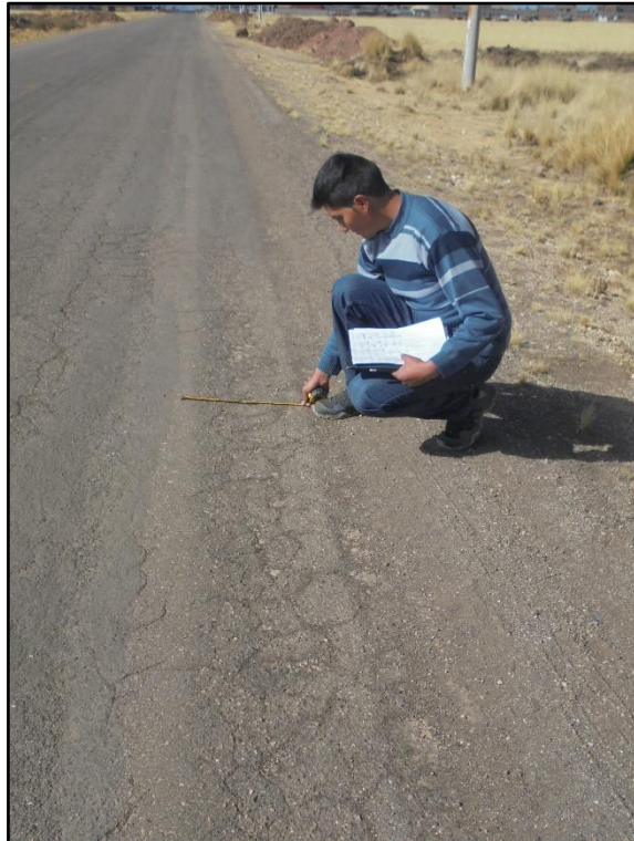
Fotografía N° 8. Falla tipo 15 ahuellamientos en la superficie de las huellas de la rueda. Km 33+290.
