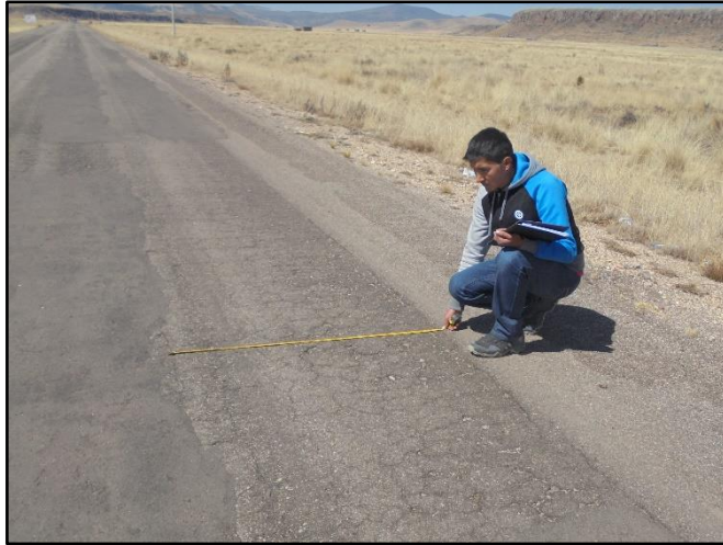
Fotografía N° 4. Falla 1 piel de cocodrilo severidad media.
