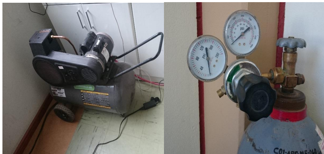
Equipos de compresora de aire y de balon de nitrógeno para barrido
