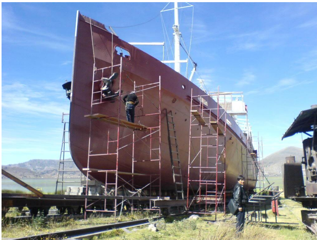
IMAGEN N° 32: Vista de un vapor en reparación en la grada del astillero de Huaje. FUENTE: Autor de la Investigación. 2015.
