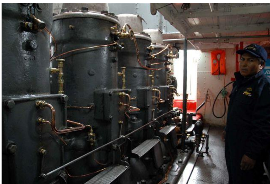
IMAGEN N° 25: Sala de Máquinas de la remodelada Yavarí. FUENTE: Fundación "Yavarí" 2006.
