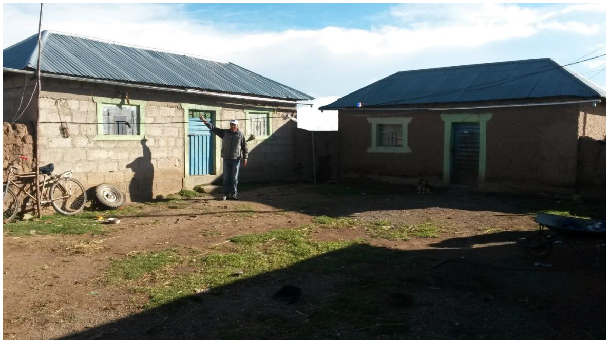
DIAGNOSTICO DE LAS CALAMINAS DE LA VIVIENDA ESTUDIADA PARA LA CAPTACIÓN DE AGUA DE LLUVIA.
