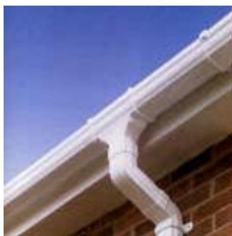
Figura 4: CANALETAS DE RECOLECCIÓN.
