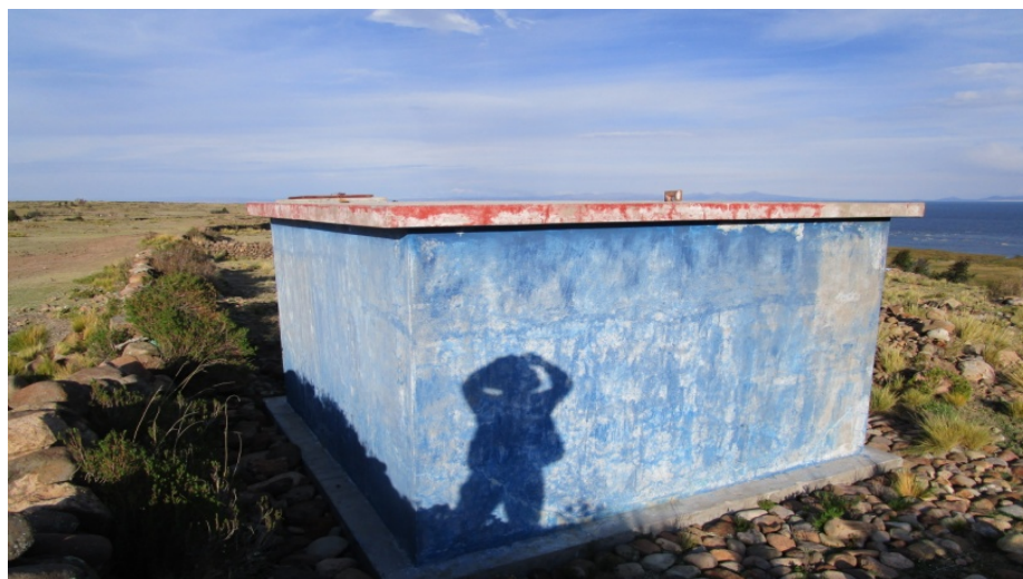
Figura N° 05: Cisterna de concreto de 40m 3 Fuente: Elaboración propio.
