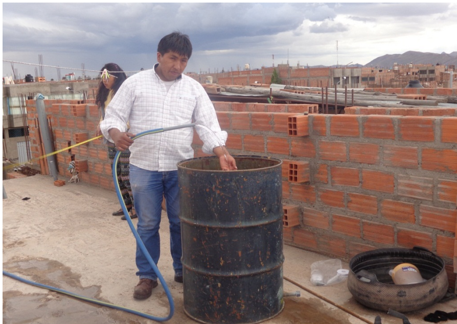
Agua Bombeada con el Ariete Hidráulico de 2" a 7m
