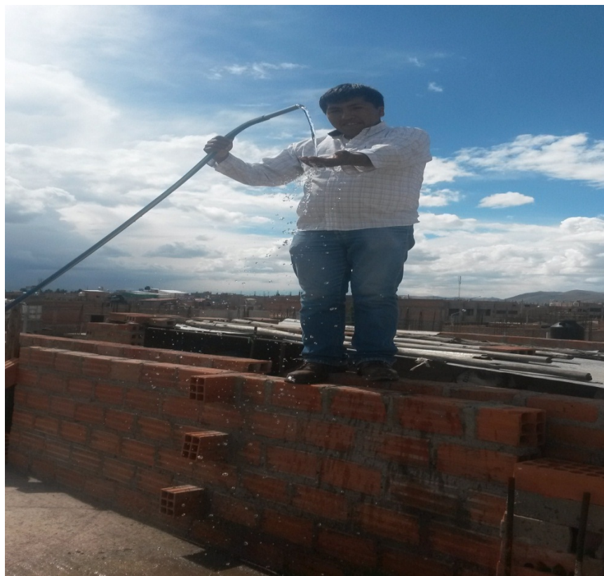
Agua Bombeada con Ariete Hidráulico a 11m de altura
