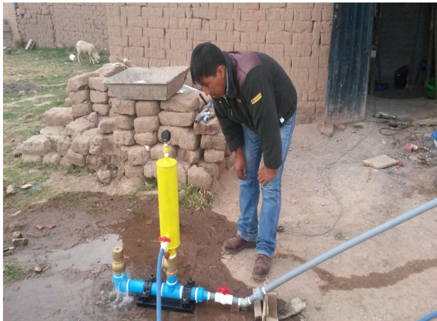
Funcionamiento del Ariete Hidráulico
