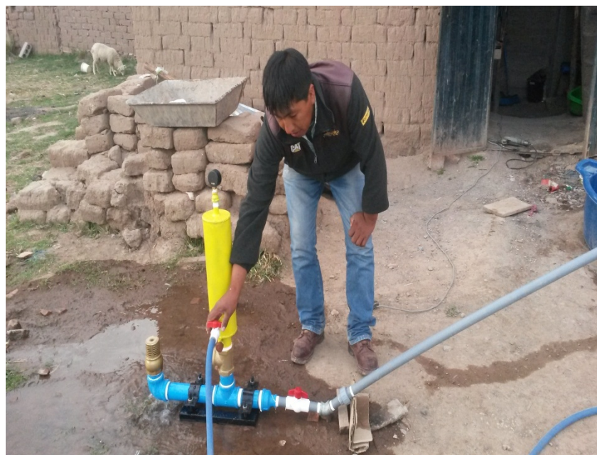
Apertura de Válvula de paso para su descarga
