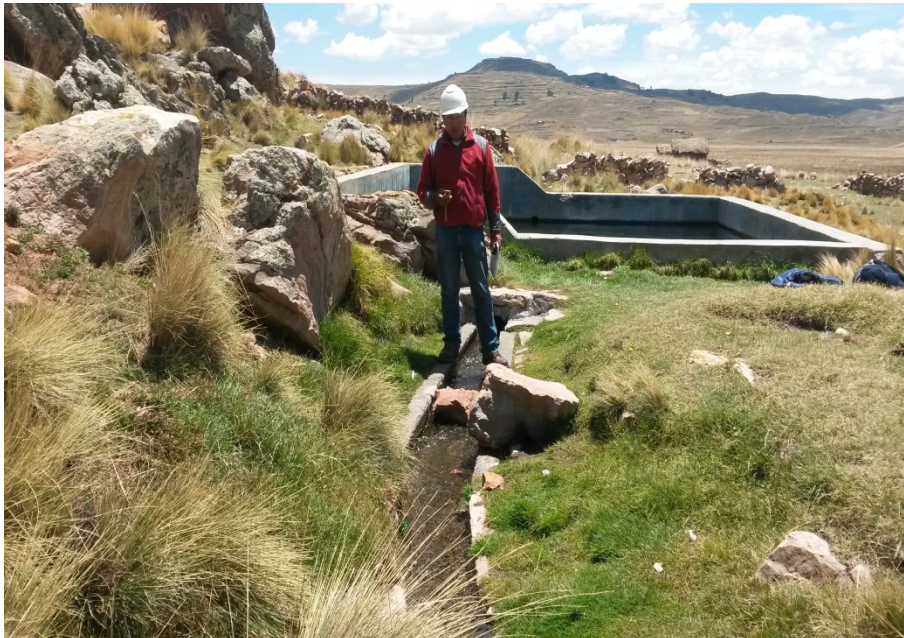
Manantial de Putina-Quequerana de donde se captara el agua para su bombeo con el Ariete Hidráulico
