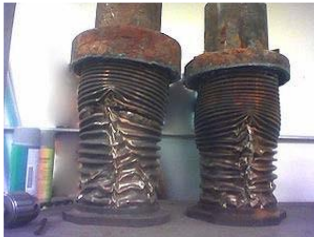
Figura 4: Tuberías estropeadas por la depresión provocada por el golpe de ariete.
