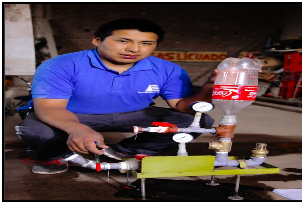
Fotografías 7: Se aprecia la instalación completa de la bomba de ariete hidráulico.
