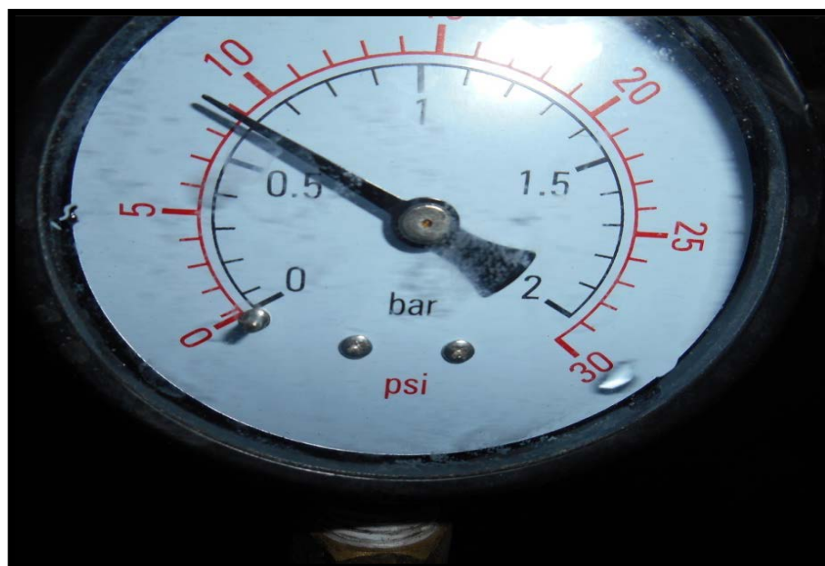
Fotografías 11: Se aprecia en manómetro la presión existente de la tubería de elevación de 1/2".
