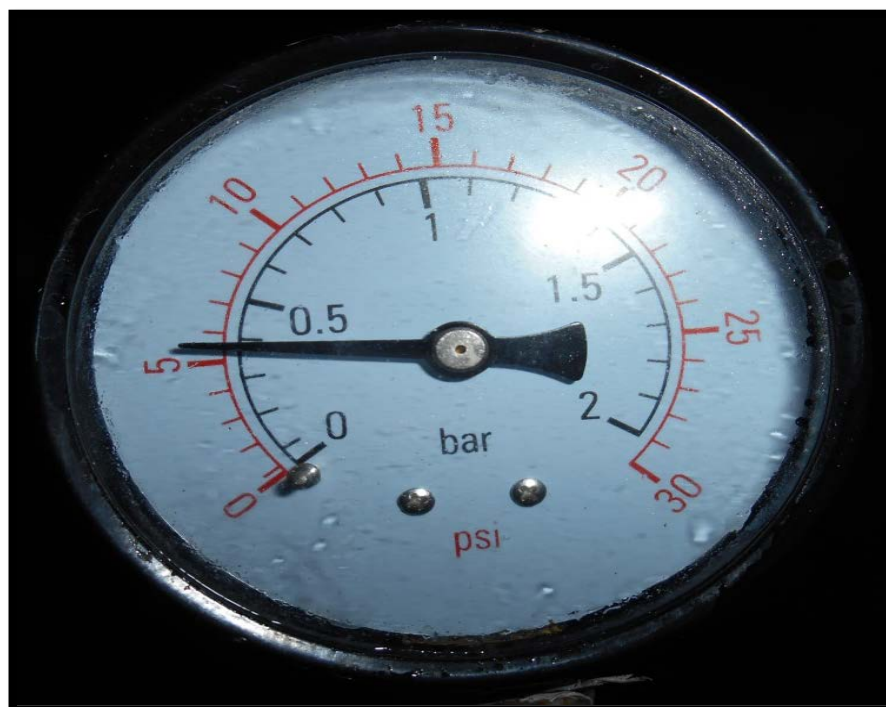
Fotografías 10: Se aprecia en manómetro la presión existente de la tubería de alimentación de 1" pvc.
