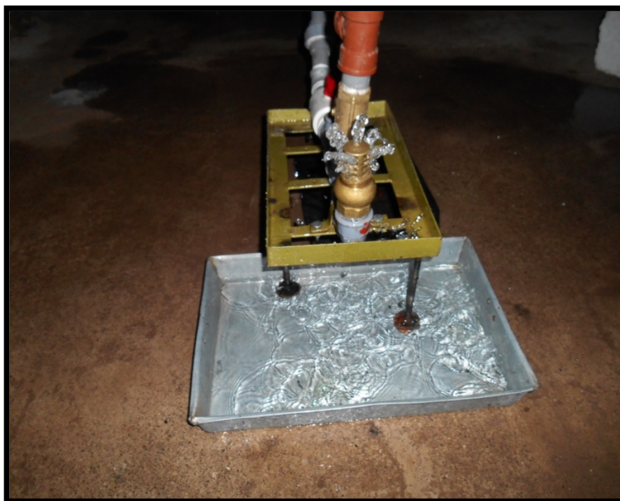
Fotografías 12: Se aprecia el desperdicio de la válvula check de fondo de 1" cobre
