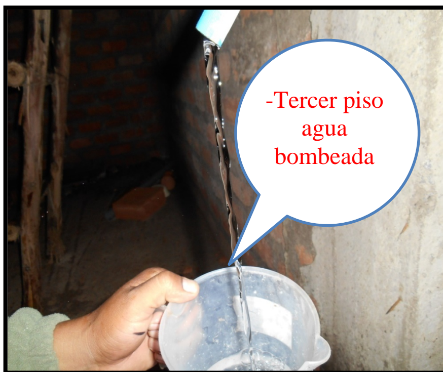
Fotografías 16: Se aprecia el chorro de agua que se eleva a una altura mayor.
