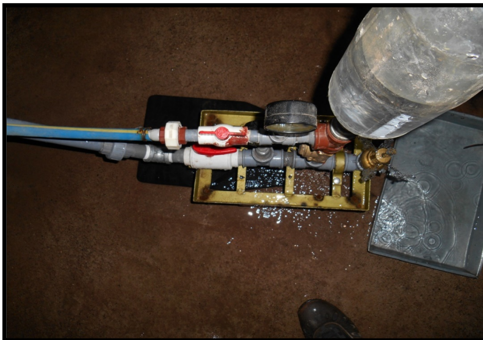
Fotografías 9: Se aprecia la apertura de la válvula de control abierta al 100% instalación completa de la bomba de ariete hidráulico.
