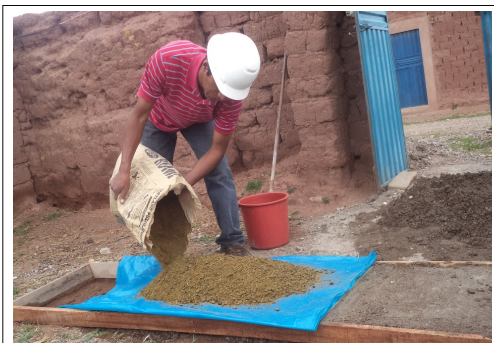
VISTA 04: EN LA VISTA SE MUESTRA EL COLOCADO DE COBERTURAS DE CONCRETO FRESCO CON PLASTICO Y GUANO.
