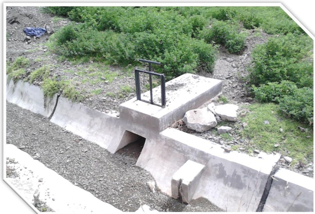
CONPUERTA DEL CANAL SUB LATERAL DE LA IRRIGACIÓN CABANILLA.
