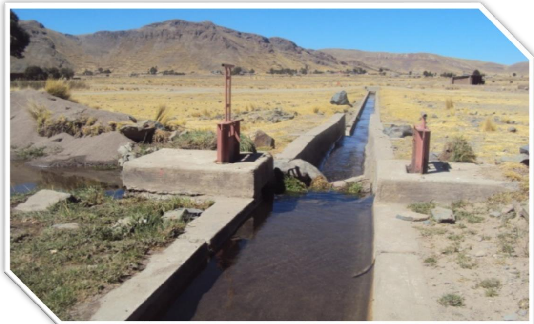
CANAL LATERAL Y COMPUESTAS SUB LATERALES EN LA IRRIGACION CABANILLA.
