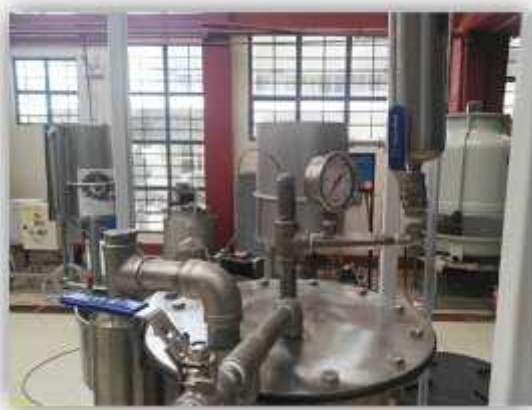
Figura N° 14: Head plate del RAFA con manómetro instalado.
