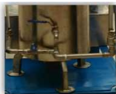
Figura N° 12: Primera Parte del Reactor Anaeróbico de Flujo Ascendente (RAFA).
