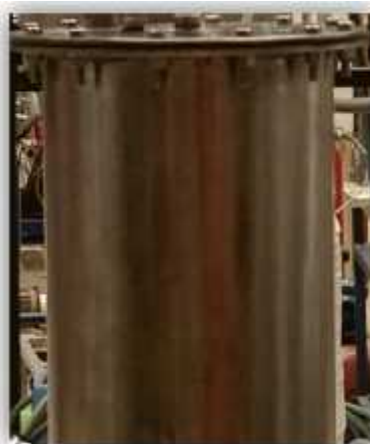
Figura N° 13: Parte superior del Reactor Anaeróbico de Flujo Ascendente (RAFA).
