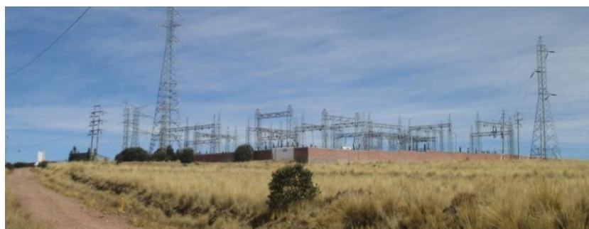
FIGURA 184: Planta de Transmisión Eléctrica– Sector Totorani.
