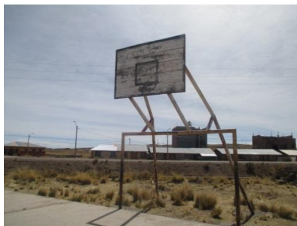
FIGURA 177: Estado de Conservación de la infraestructura deportiva Urb. Ciudad de la Humanidad.
