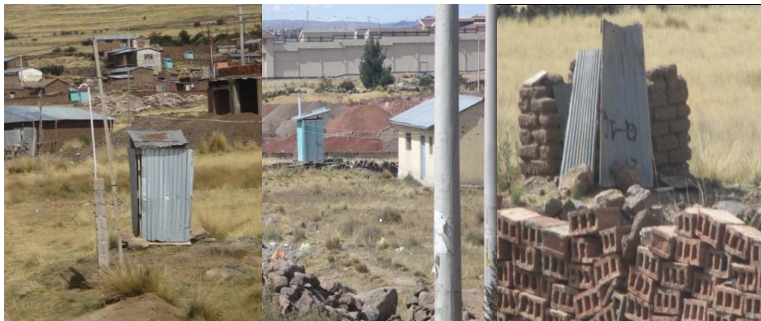
FIGURA 183: Letrinas y Pozos Sépticos– Sector Totorani.
