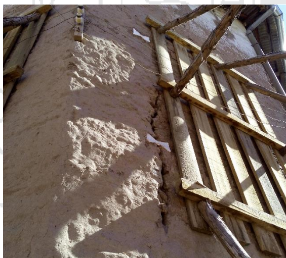
Figura 3.17. Daños visibles del muro lado este de la Capilla.
