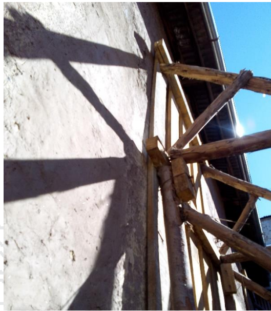
Figura 3.20. Falla por empuje de muros apuntalados.
