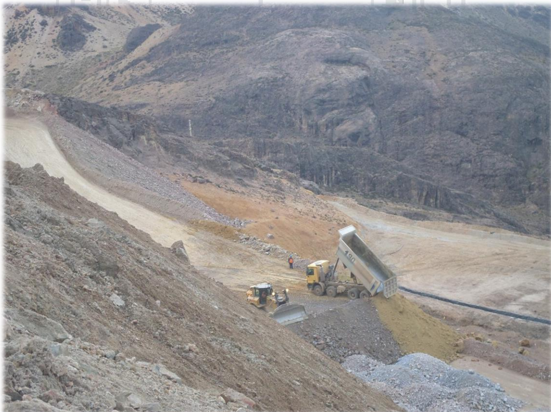
Foto 4. Descarga de desmote y oxido en Botadero Jesica Lift 1
