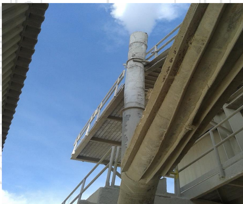
Fig. 19. Chimenea extractora de vapor de agua.
