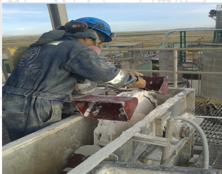
Fig. 28. Reemplazo de cangilones elevador 850.
