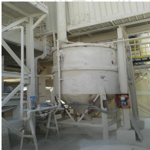
Fig. 21. Tanque de agua 5 m 3 .
