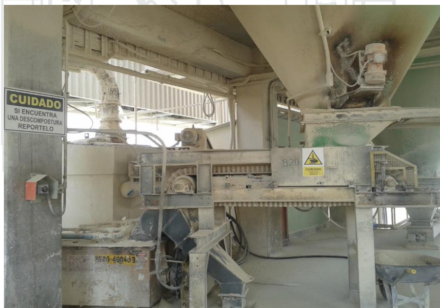
Fig. 15. Tolvas de alimentación con motor vibratorio.
