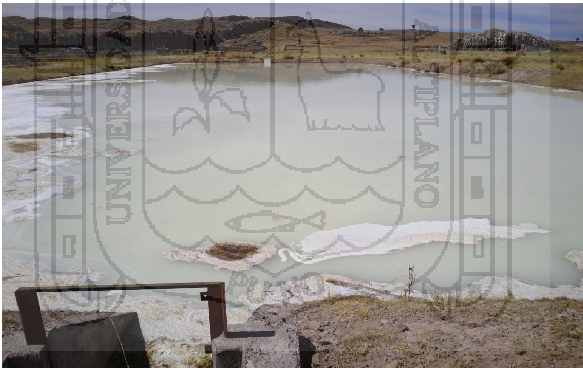
Laguna de oxidación de aguas residuales domésticos distrito de Huata, se observa flotación de grasas que afecta el tratamiento en la laguna
