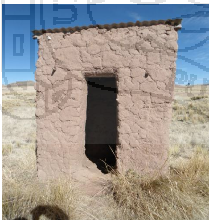
Letrina sin puerta y sin ventilador
