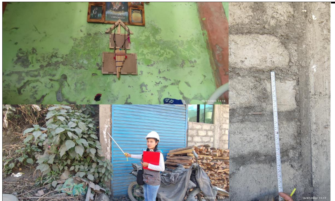
FOTO 50: EN LA VIVIENDA N°25 SE OBSERVA HUMEDAD Y DERRUMBES
