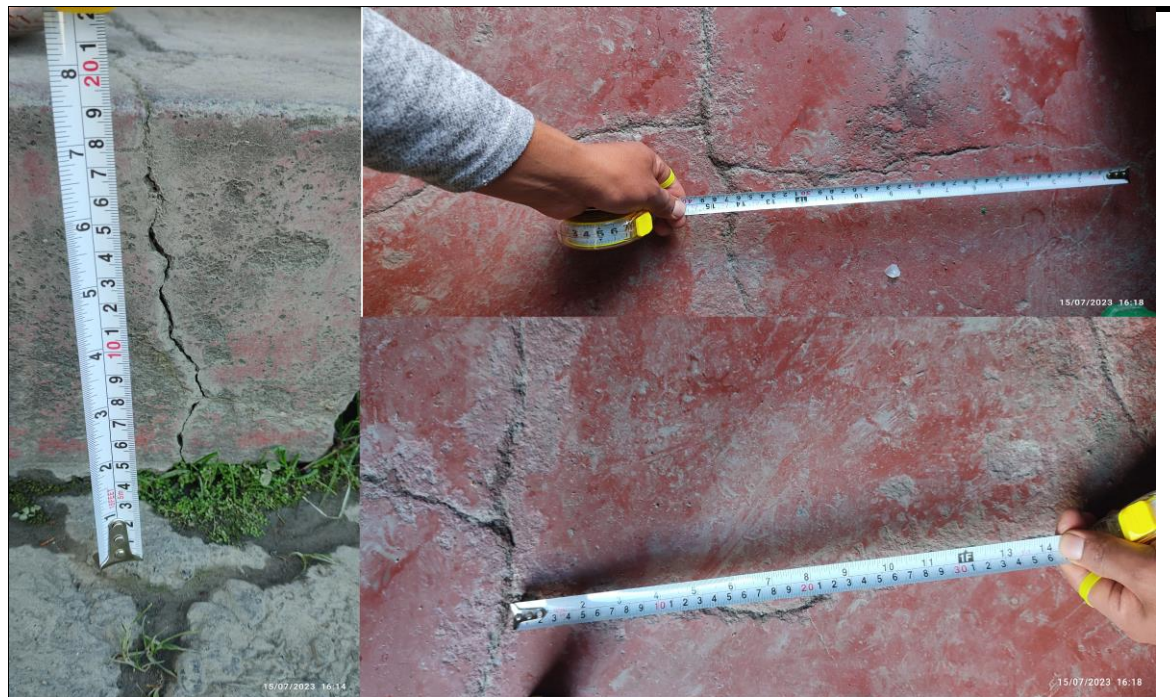
FOTO 26: EN LA VIVIENDA N°13 SE OBSERVA LAS FISURAS
