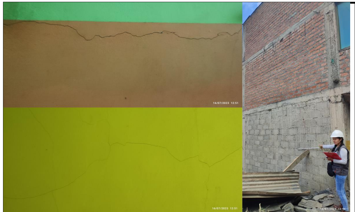
FOTO 62: EN LA VIVIENDA N°31 SE OBSERVA LAS FISURAS
