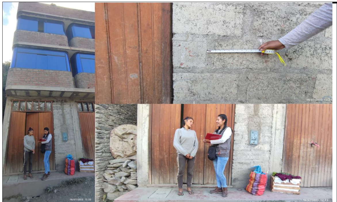
FOTO 60: EN LA VIVIENDA N°30 SE OBSERVA LAS FISURAS Y HUMEDAD
