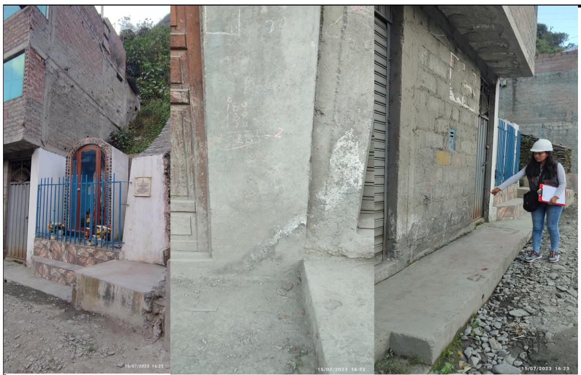
FOTO 26: EN LA VIVIENDA N°14 SE OBSERVA EFLORESCENCIA
