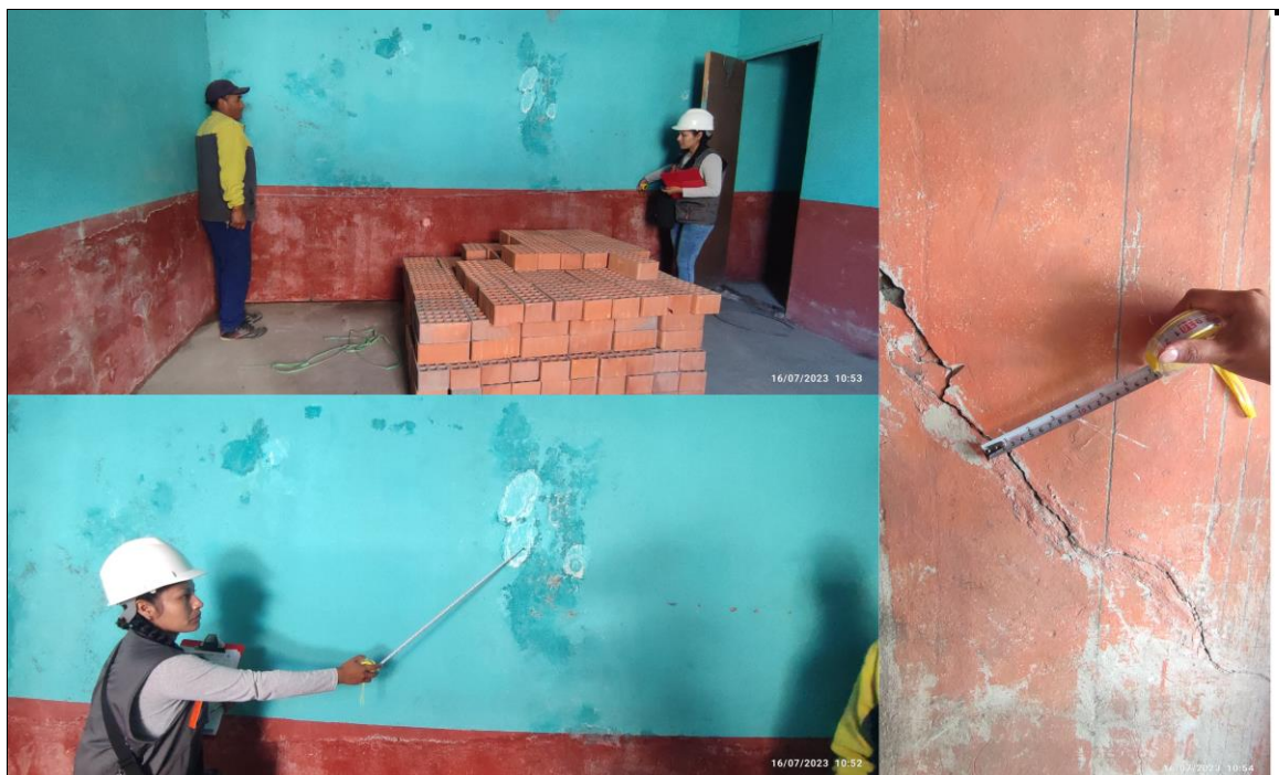
FOTO 48: EN LA VIVIENDA N°24 SE OBSERVA HUMEDAD Y FISURAS
