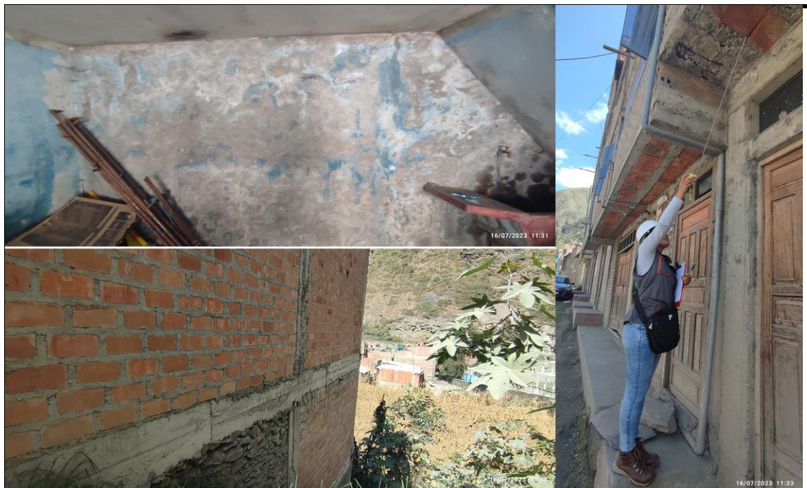
FOTO 52: EN LA VIVIENDA N°26 SE OBSERVA EFLORESCENCIA DEFORMACIONES
