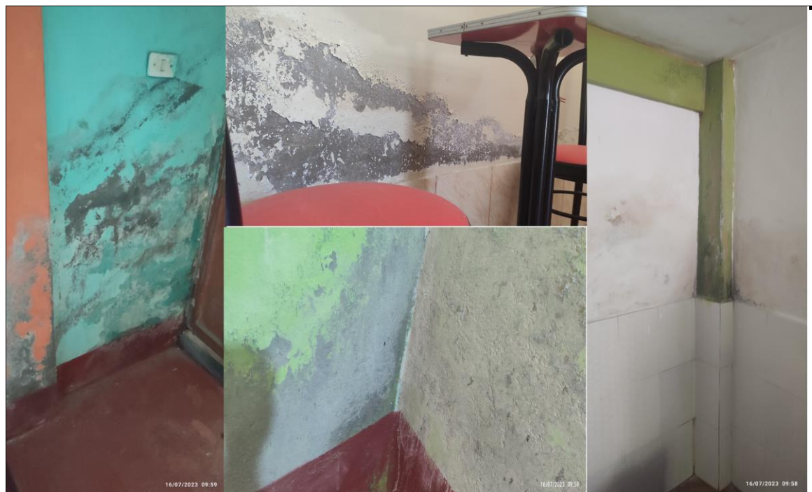
FOTO 44: EN LA VIVIENDA N°22 SE OBSERVA EFLORESCENCIA Y HUMEDAD
