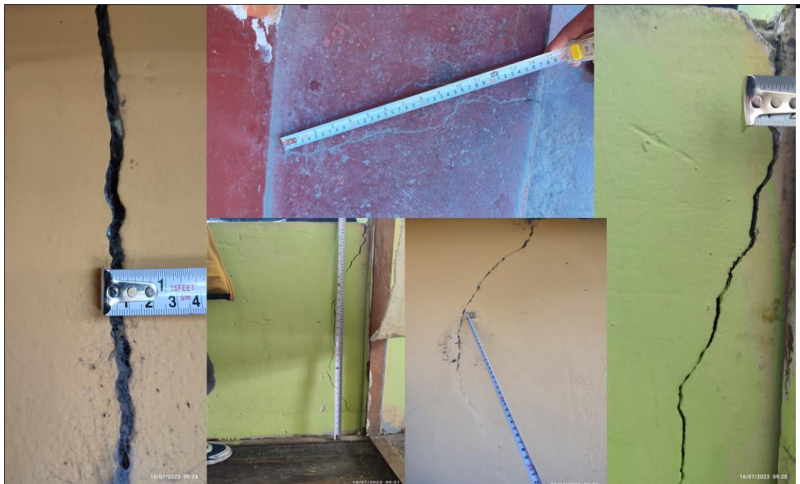
FOTO 40: EN LA VIVIENDA N°20 SE OBSERVA LAS FISURAS Y GRIETAS
