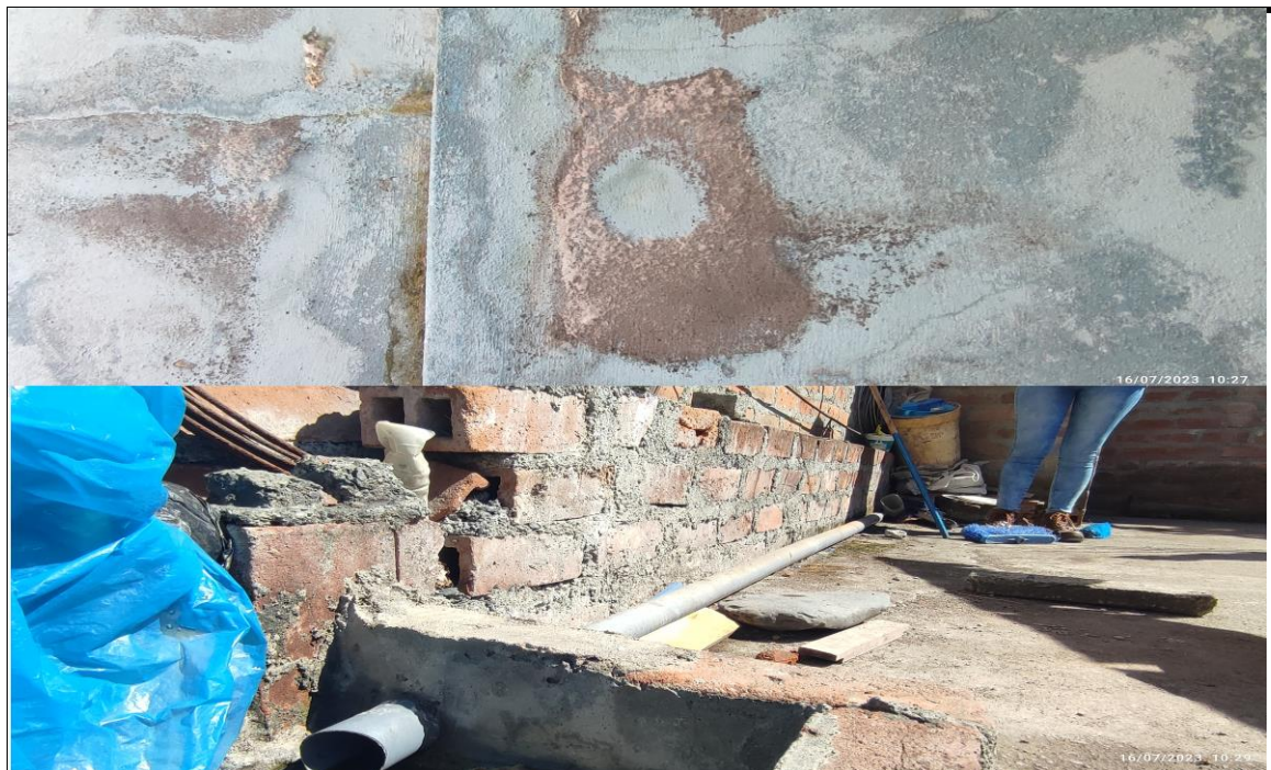
FOTO 54: EN LA VIVIENDA N°27 SE OBSERVA EFLORESCENCIA - FISURAS
