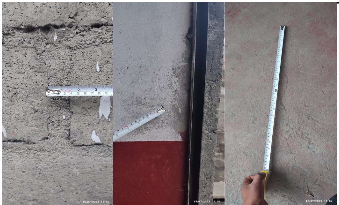
FOTO 34: EN LA VIVIENDA N°17 SE OBSERVA LAS FISURAS Y HUMEDAD
