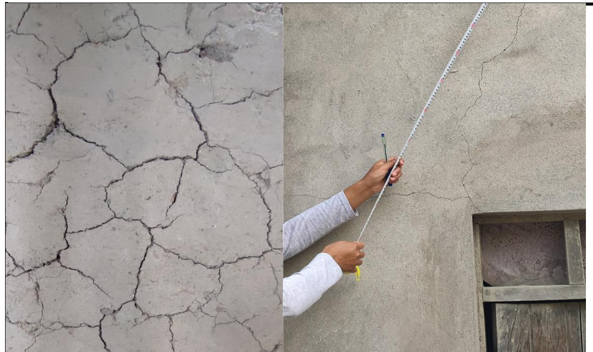
FOTO 02: EN LA VIVIENDA N°01 SE OBSERVA LAS FISURAS
