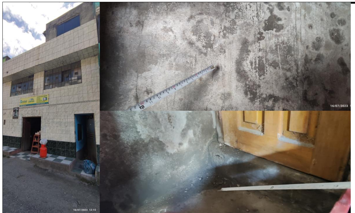
FOTO 58: EN LA VIVIENDA N°29 SE OBSERVA EFLORESCENCIA Y HUMEDAD
