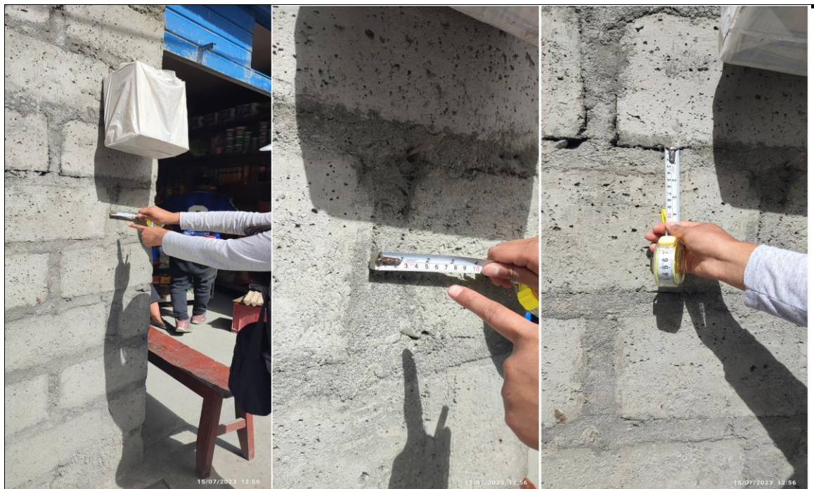
FOTO 20: EN LA VIVIENDA N°10 SE OBSERVA LAS JUNTAS - HUMEDAD
