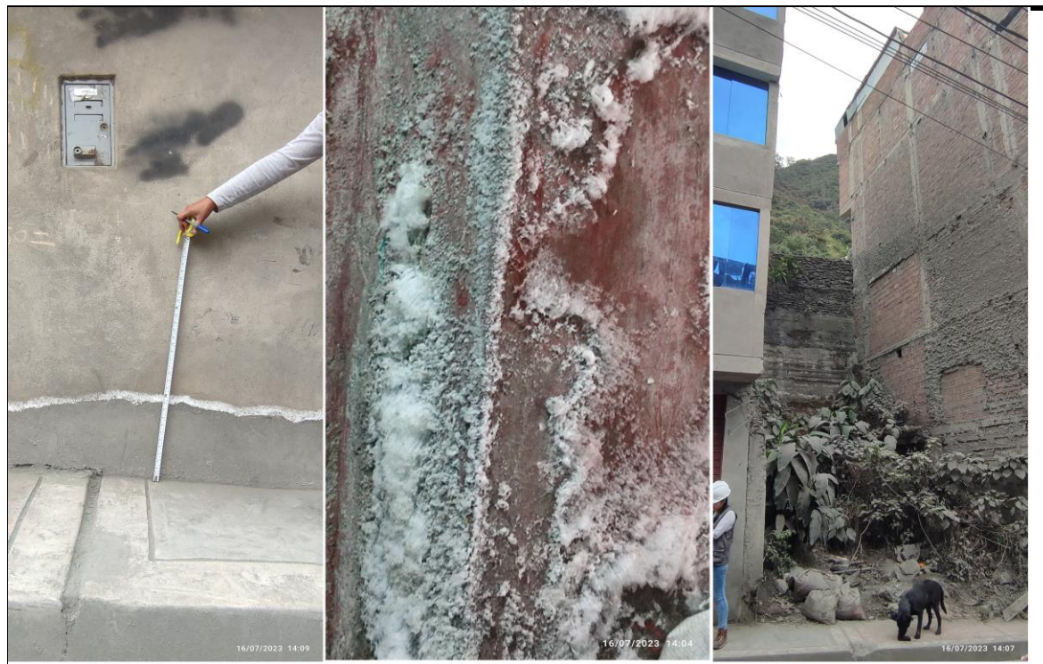
FOTO 70: EN LA VIVIENDA N°35 SE OBSERVA EFLORESCENCIA
