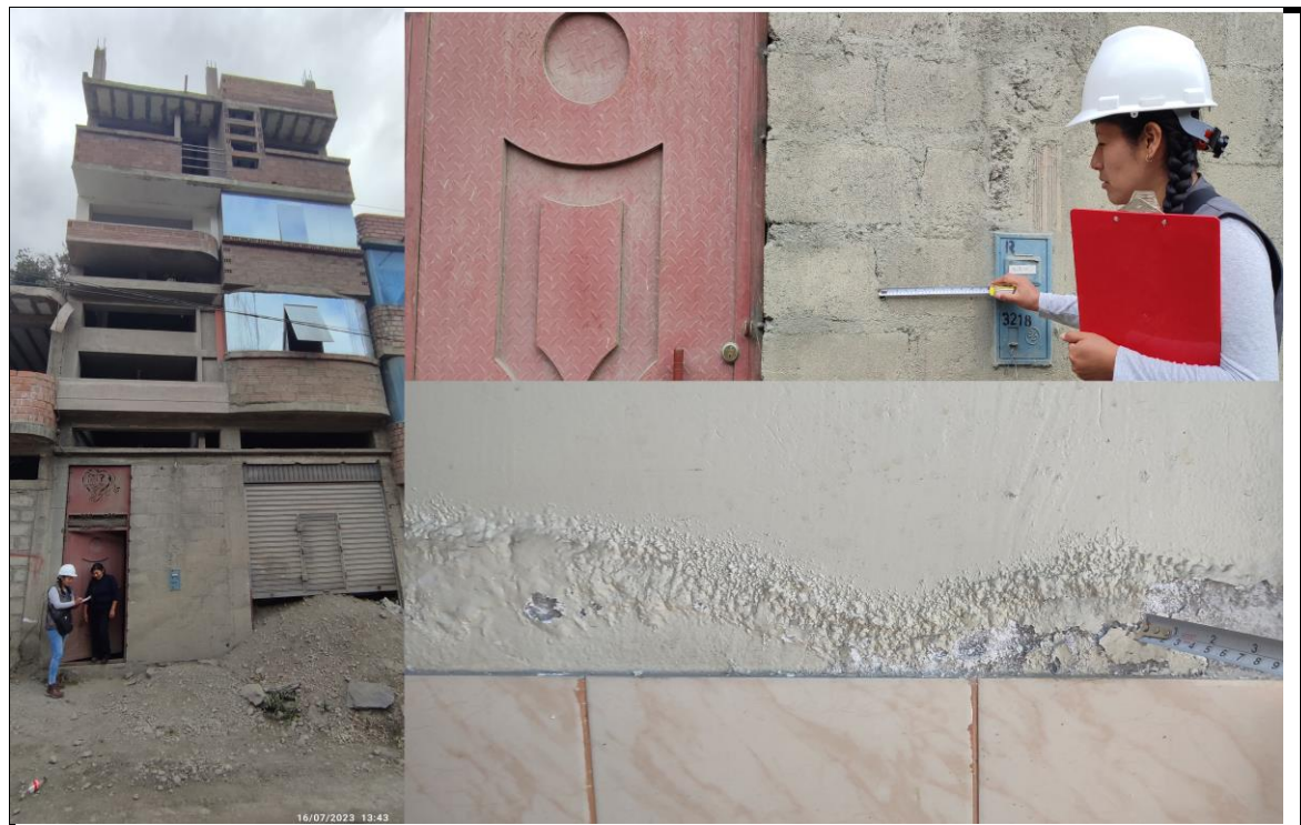
FOTO 66: EN LA VIVIENDA N°33 SE OBSERVA EFLORESCENCIA - FISURAS - JUNTAS
