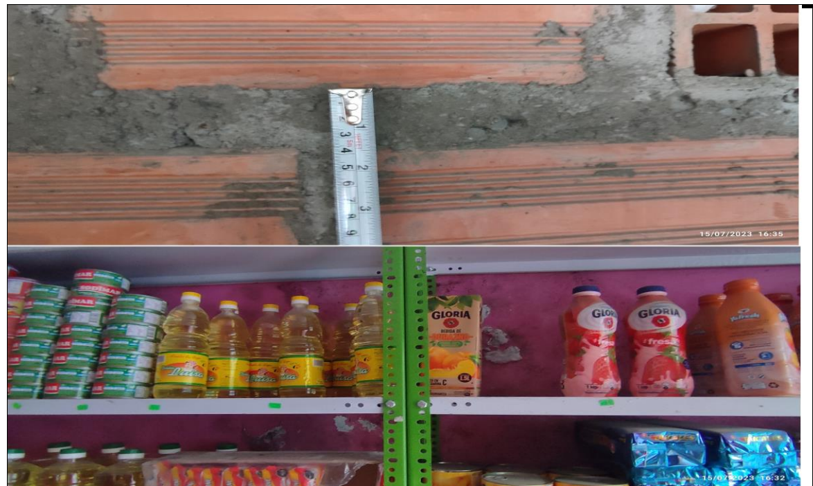
FOTO 30: EN LA VIVIENDA N°15 SE OBSERVA HUMEDAD
