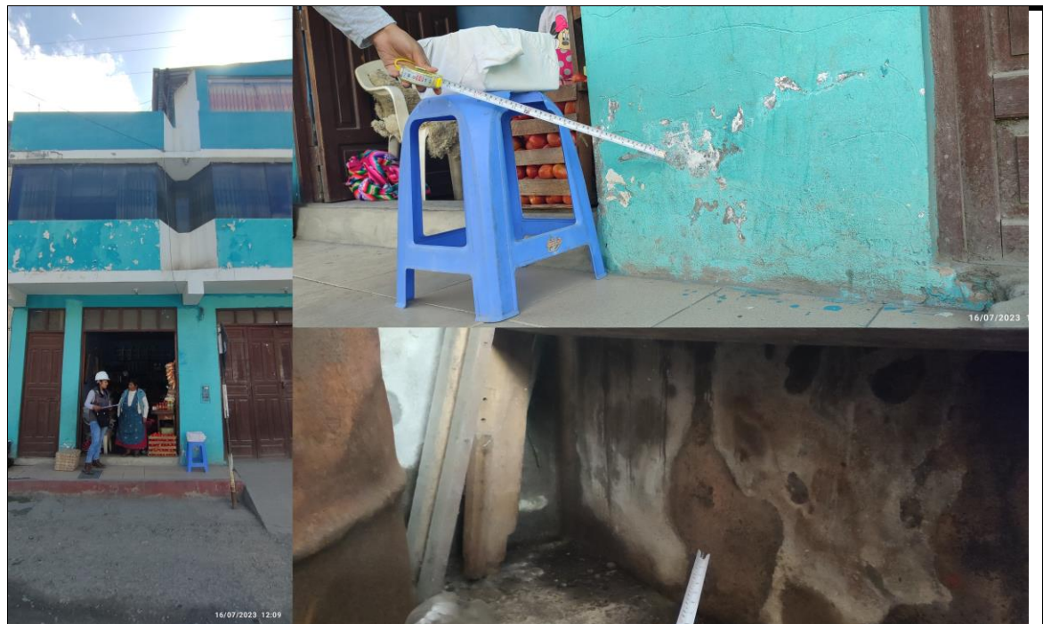
FOTO 56: EN LA VIVIENDA N°28 SE OBSERVA HUMEDAD Y EFLORESCENCIA
