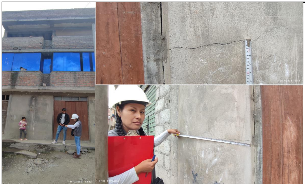
FOTO 64: EN LA VIVIENDA N°32 SE OBSERVA LAS FISURAS
