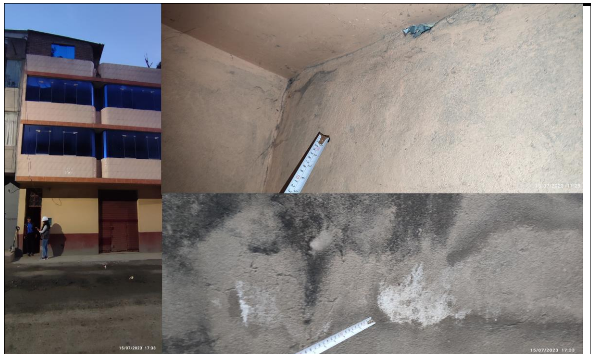
FOTO 36: EN LA VIVIENDA N°18 SE OBSERVA EFLORESCENCIA Y HUMEDAD
