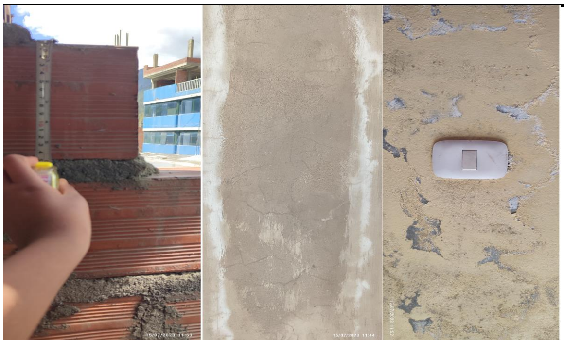
FOTO 10: EN LA VIVIENDA N°05 SE OBSERVA EFLORESCENCIA
