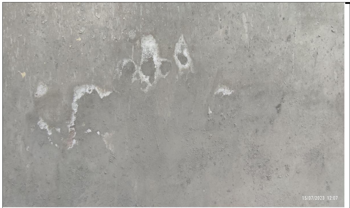
FOTO 12: EN LA VIVIENDA N°06 SE OBSERVA EFLORESCENCIA
