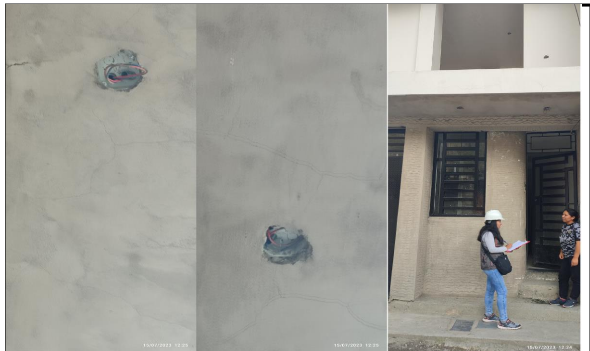
FOTO 14: EN LA VIVIENDA N°07 SE OBSERVA LAS FISURAS
