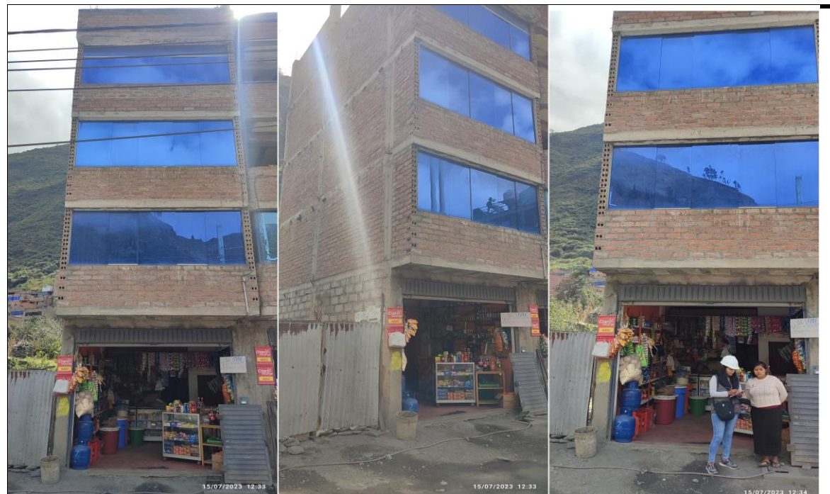
FOTO 16: EN LA VIVIENDA N°08 SE OBSERVA LAS DEFORMACIONES Y EFLORESCENCIA
