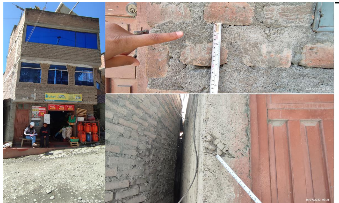
FOTO 42: EN LA VIVIENDA N°21 SE OBSERVA CANGREJERAS Y JUNTAS
