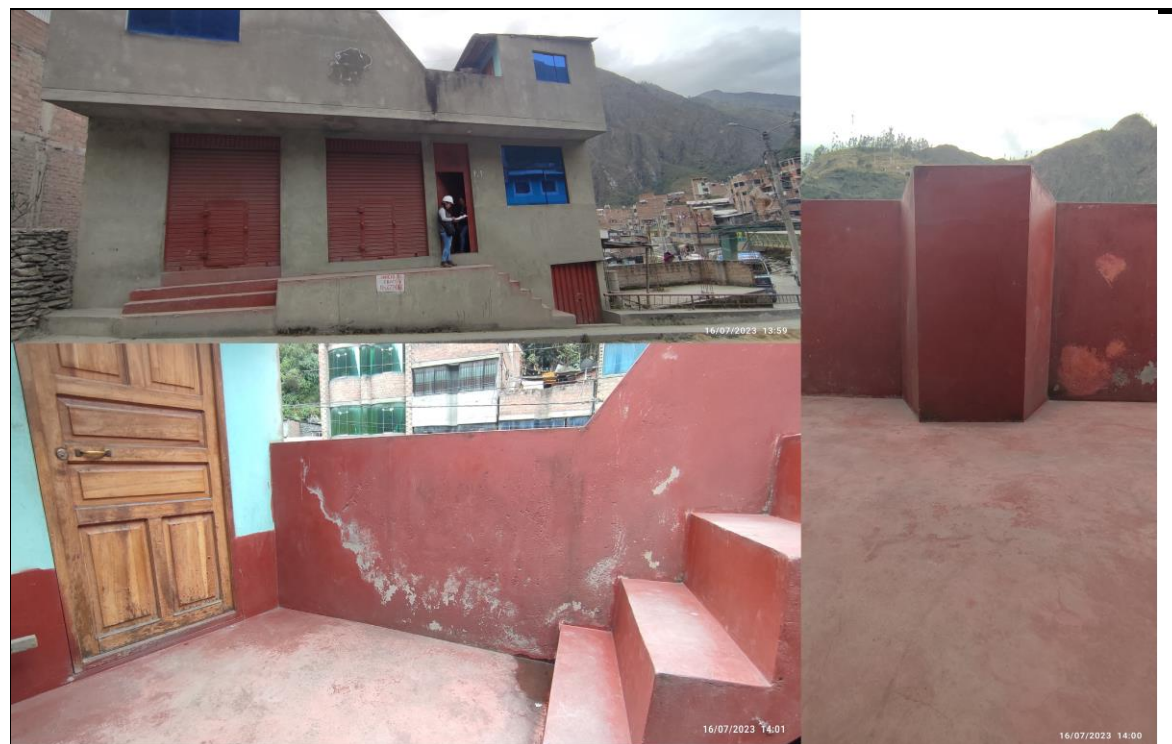
FOTO 68: EN LA VIVIENDA N°34 SE OBSERVA EFLORESCENCIA
