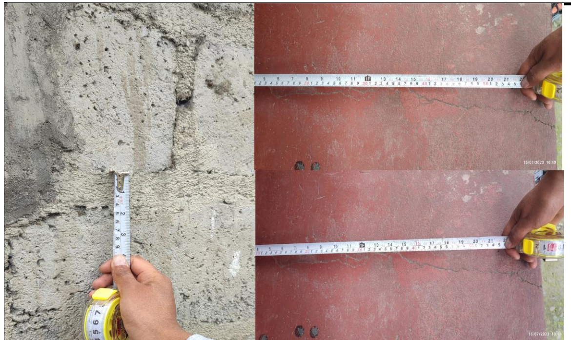
FOTO 04: EN LA VIVIENDA N°02 SE OBSERVA LAS FISURAS
