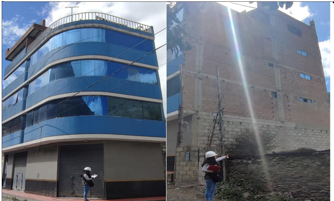
FOTO 08: EN LA VIVIENDA N°04 SE OBSERVA LAS GRIETAS
