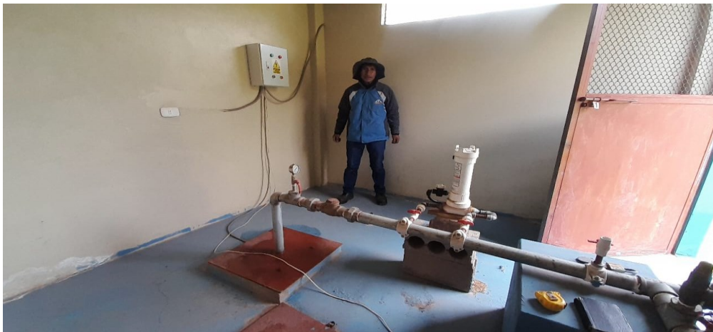
En la Foto se aprecia módulo de bomba eléctrica en la caceta de bombeo
