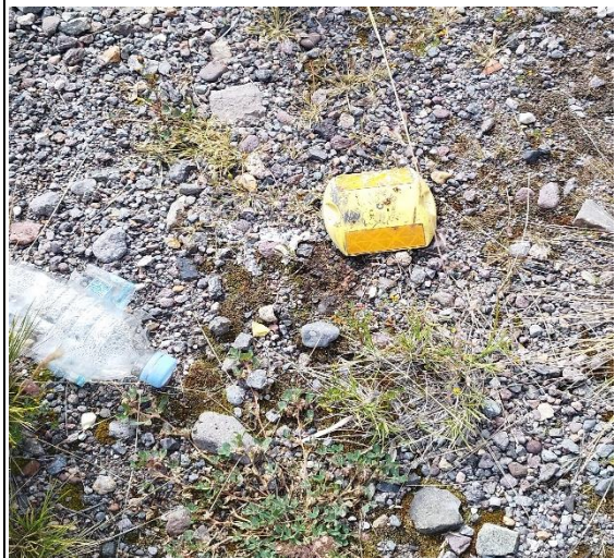
Punto negro 11: Tachas desprendidas
