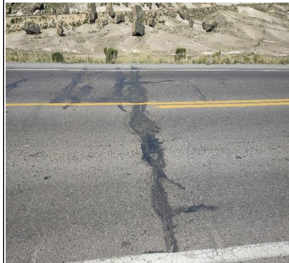
Punto negro 04: Fisuras en el pavimento
