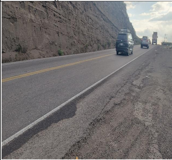
Punto negro 02: Ausencia de tachas
