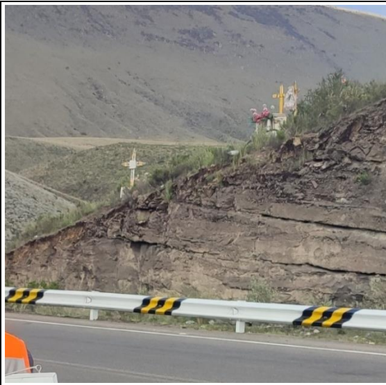
Punto negro 02: Presencia de nichos
