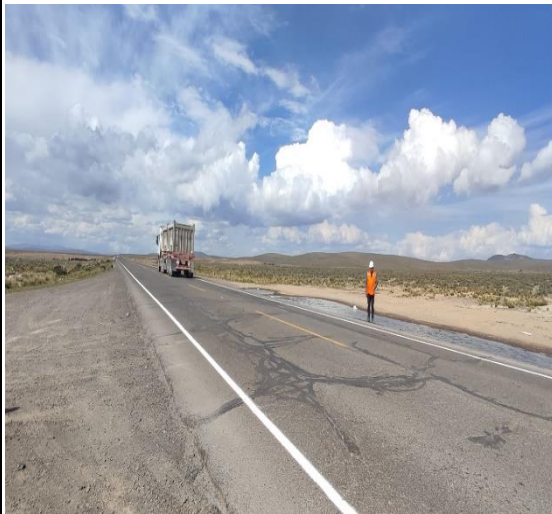
Punto negro 05: Fisuras en el pavimento
