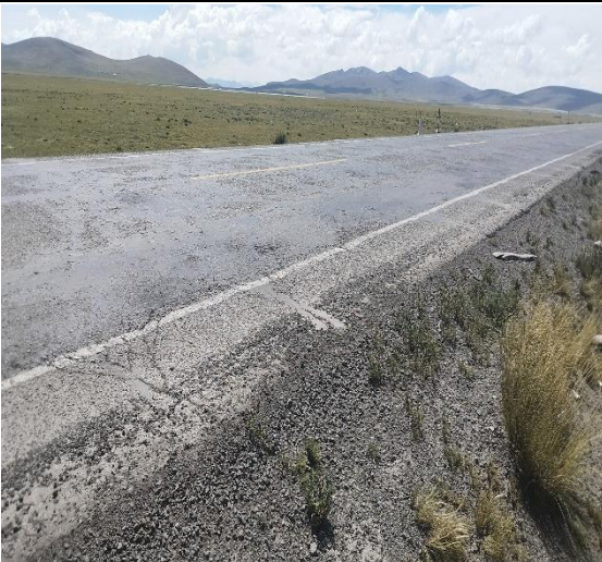
Punto negro 07: Estado deteriorado de la berma
