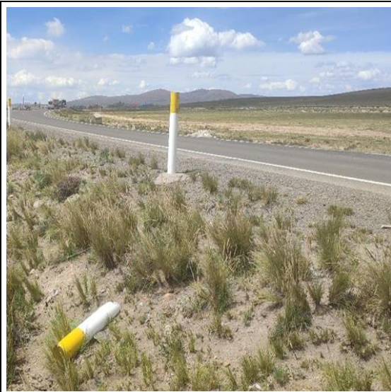
Punto negro 06: Postes delineadores destruidos
