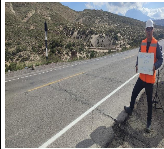
Punto negro 03: Fisuras en el pavimento
