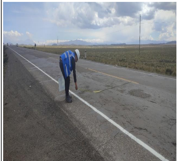
Punto negro 06: Fisuras en el pavimento
