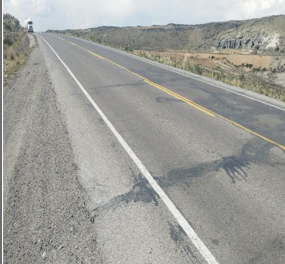
Punto negro 04: Estado de la berma
