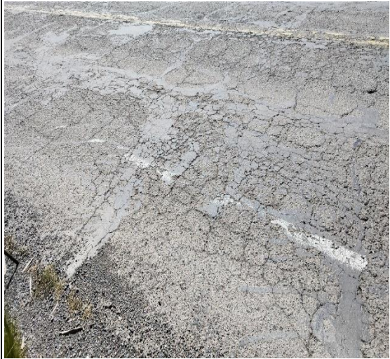
Punto negro 09: Pavimento deteriorado
