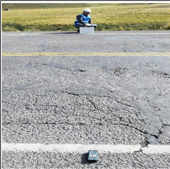
Punto negro 11: Fisuras en el pavimento
