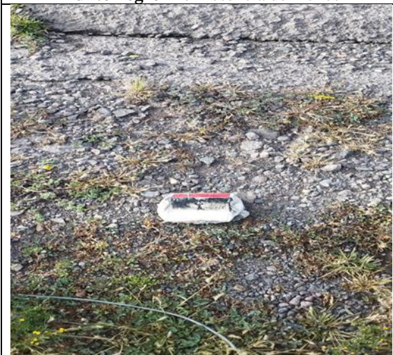
Punto negro 12: Tachas desprendidas.
