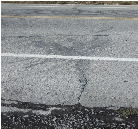
Punto negro 10: Fisuras en el pavimento
