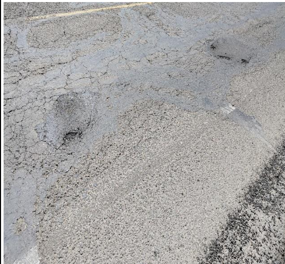
Punto negro 08: Ahuellamiento en pavimento
