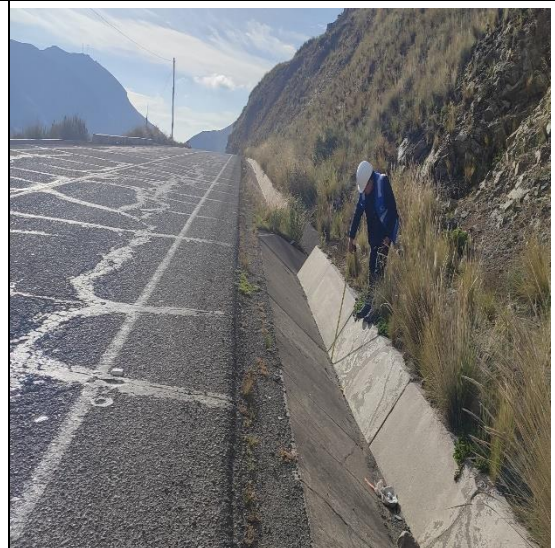
Punto negro 12: Fisuras en el pavimento
