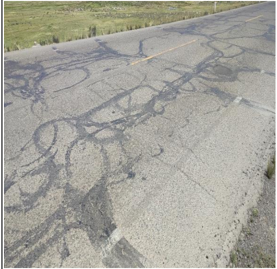
Punto negro 08: Fisuras en el pavimento
