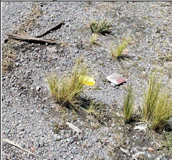
Punto negro 09: Tachas desprendidas
