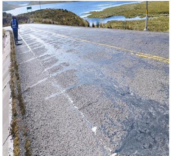
Punto negro 10: Pavimento deteriorado
