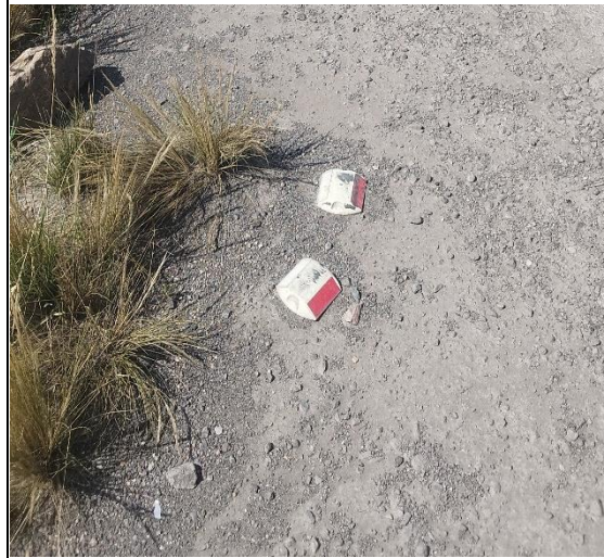
Punto negro 05: Desprendimiento de tachas
