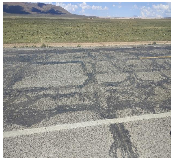
Punto negro 07: Fisuras en el pavimento
