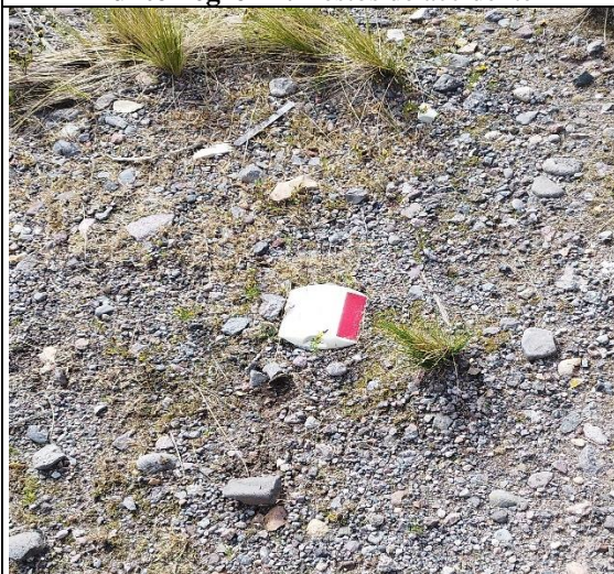
Punto negro 11: Tachas desprendidas
