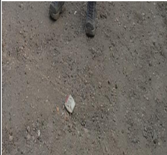
Punto negro 01: Desprendimiento de tachas
