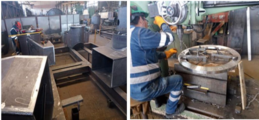
a. ARMADO BUZON ENTRADA Y SALIDA
