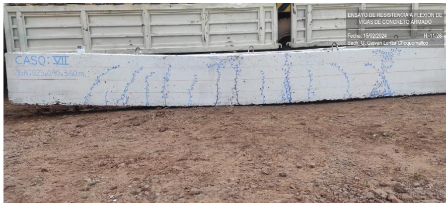
Fotografía 22: Ensayo de resistencia a flexión y fisuras de vigas de concreto armado para el Caso VII.
