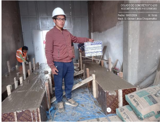
Fotografía 09: Colado o vaciado de concreto en las vigas para todos los casos estudiados.
