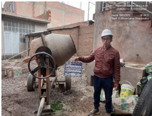
Fotografía 06: Preparación de concreto de acuerdo con el diseño de mezcla para el colado de vigas.
