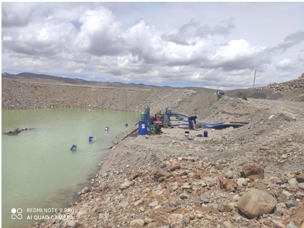
12.6 - Vista poza de captación y bombeo de agua.
