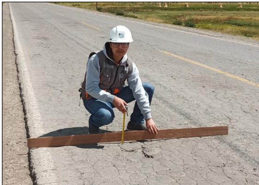
Figura 8. 8: Falla ahuellamiento en la unidad de muestreo 13. Determinación de su nivel de severidad
