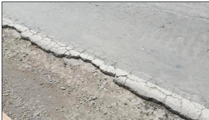
Figura 8. 5: Falla grieta de borde en la unidad de muestreo 7
