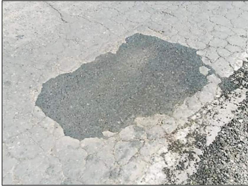
Figura 8. 7: Falla parcheo en la unidad de muestreo 14
