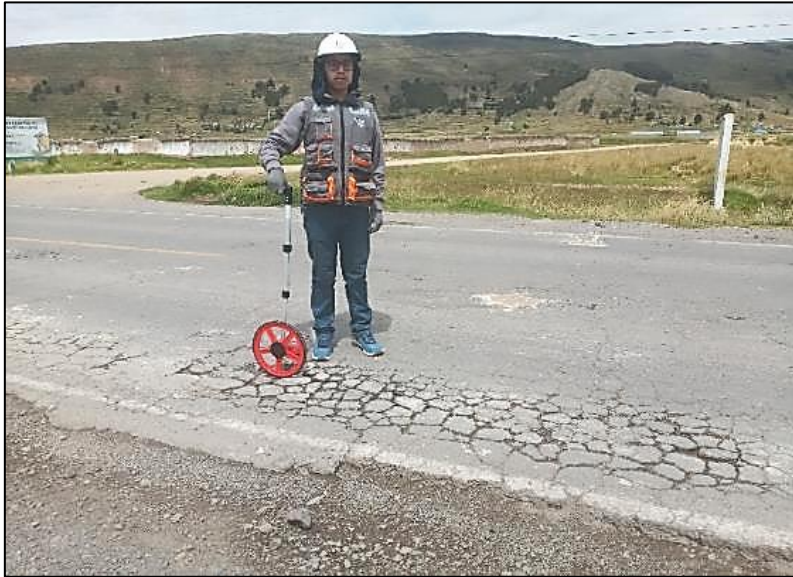
Figura 8. 4: Falla piel de cocodrilo en la unidad de muestreo 8
