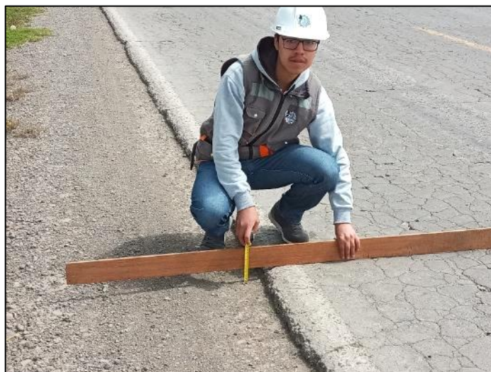
Figura 8. 6: Falla desnivel carril / berma en la unidad de muestreo 13. Determinación de su nivel de severidad
